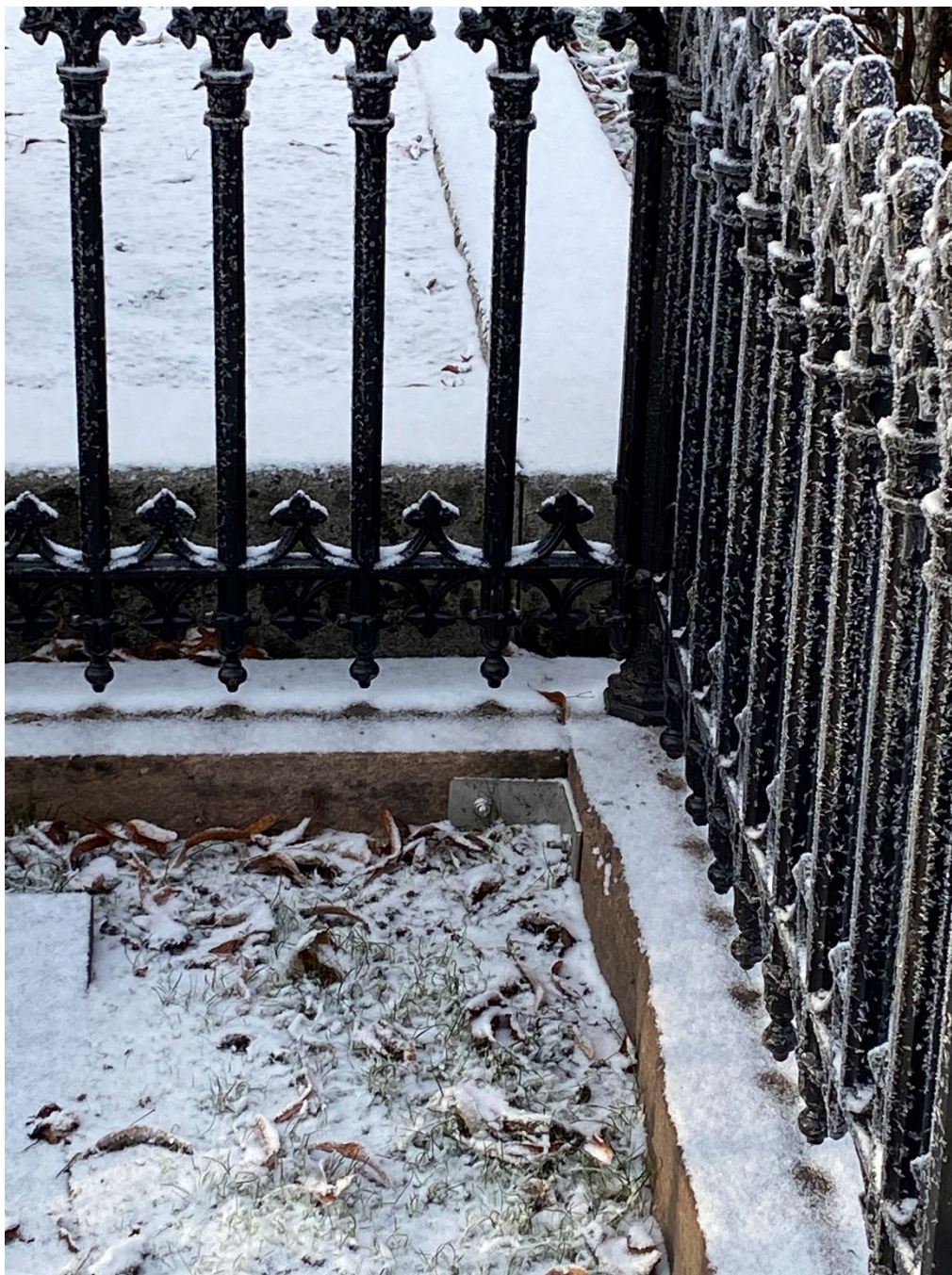
Figur 29. GK07 0116 efter åtgärd. Exempel på när sockelstenen är släthuggen endast allra högst upp på insidan och det därför blir nödvändigt att montera kramlingen högst upp. Under nästa säsong kommer marknivån att höjas och i samband med detta kommer även pulpetstenarna att lyftas upp i samma nivå. Foto: Ulrika Olsson, Läns museet Gävleborg, 2025-11-19.
