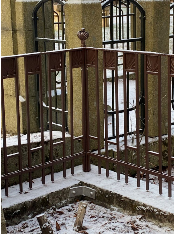
Figur 10. GK01 0167 efter åtgärd. Exempel på när sockelstenen är slätbuggen endast allra högst upp på insidan och det därför blir nödvändigt att montera kramlingen högst upp. Under nästa säsong kommer marknivån att höjas och i samband med det så kommer också den lutande stenen att lyftas upp. Foto: Ulrika Olsson, Länsmuseet Gävleborg, 2025-11-19.
