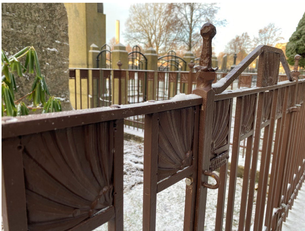
Figur 9. GK01 0167 efter åtgärd. Enligt färgdokumentationen utförd av Per Mattsson ska staketet målas i kulör NCS 8010-Y90R, mörkt brun. Staketet är nu felaktigt målat i kulör NCS S 7010-Y70R, gråbrun. Foto: Ulrika Olsson, Läns museet Gävleborg, 2025-11-19.
