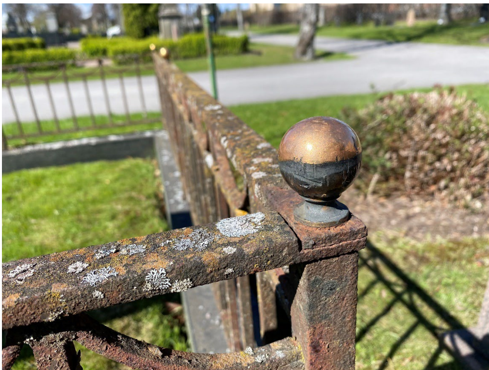
Figur 12. GK02 0006 innan åtgärd. Smidesstaketet var kraftigt rostangripet. Färgdokumentation efterfrågades. Foto: Ulrika Olsson, 2025-05-06.
