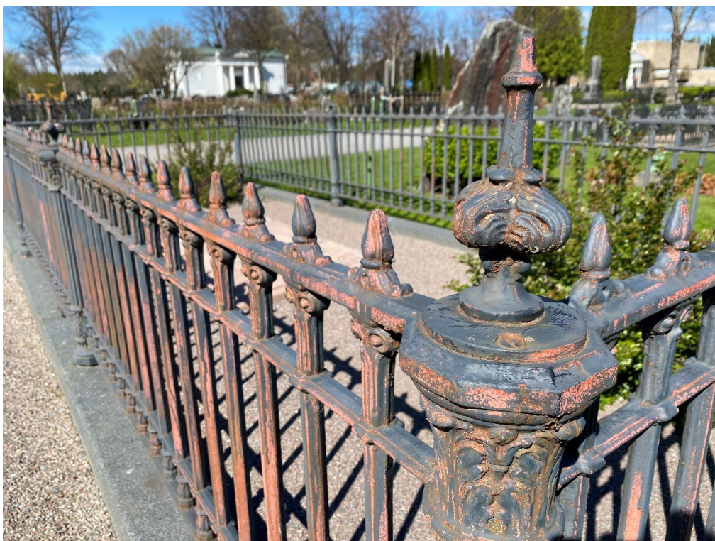
Figur 16. GK04 0007+, 0008+, 0030+ innan åtgärd. Gjutjärnsstaketet färgskikt var urlakade och den underliggande rostskyddsfärgen var synlig. Foto: Ulrika Olsson, 2025-05-06.
