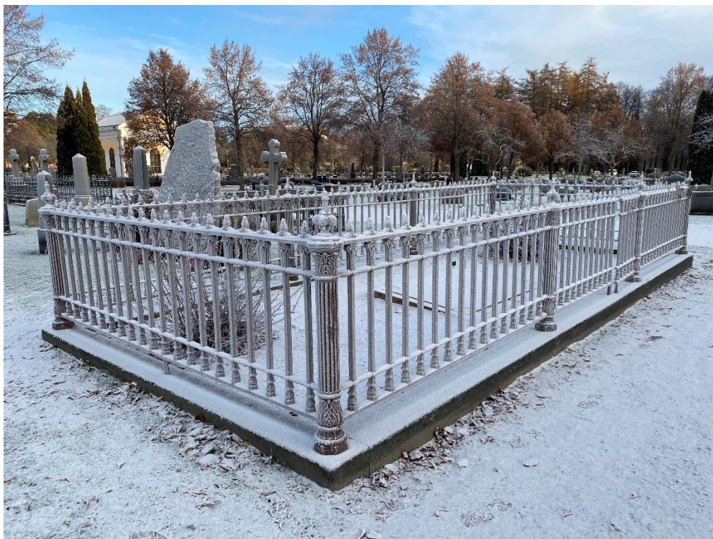
Figur 17. GK04 0007+, 0008+, 0030+ efter åtgärd. Frosten gör dock att slutresultatet inte tydligt framgår. Enligt färgdokumentationen utförd av Per Mattsson ska staketet målas i kulör NCS S 9000-N, svart. Staketet är nu felaktigt målat i kulör NCS S 7010-Y70R, gråbrun. Foto: Ulrika Olsson, Länsmuseet Gävleborg, 2025-11-19.
