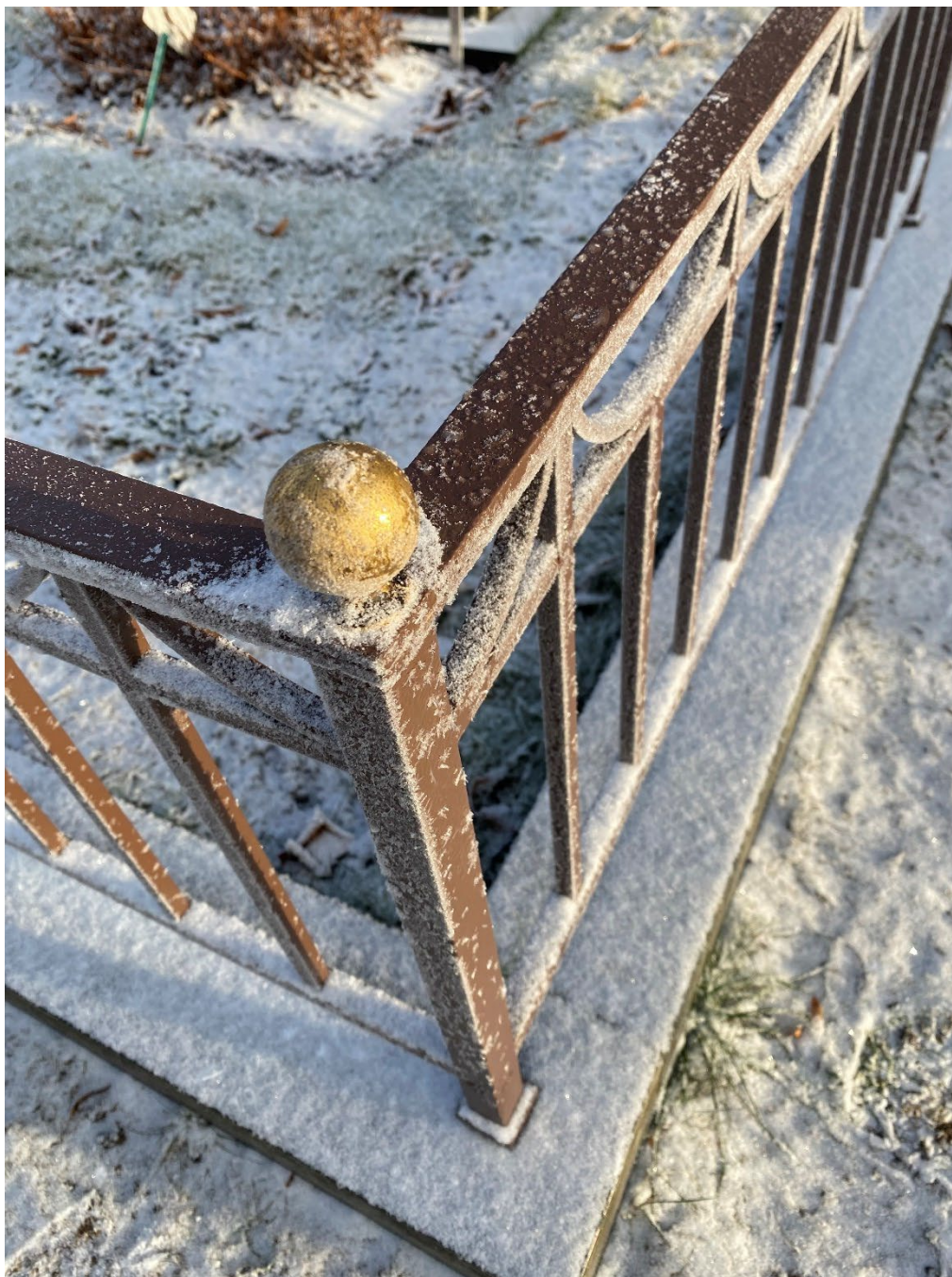
Figur 14. GK02 0006 efter åtgärd. Staketet är målat i felaktig kulör. Enligt färgdokumentationen utförd av Per Mattsson ska staketet målas i kulör NCS S 9000-N, svart. Staketet är nu målat i kulör NCS S 7010-Y70R, gråbrun. Knopparna är i massiv mässing och har lämnats utan åtgärd. Foto: Ulrika Olsson, Läns museet Gävleborg, 2025-11-19.
