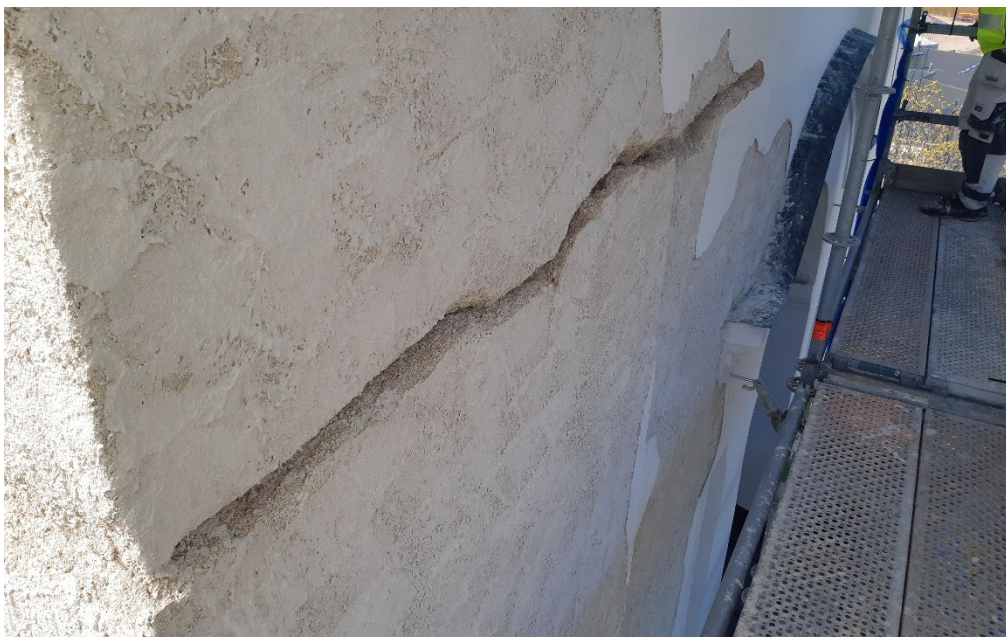
Figur 27. Upphuggen spricka på övre delen av kyrktornets norra fasad. Foto från nordöst: Daniel Olsson, 2025-05-15.
