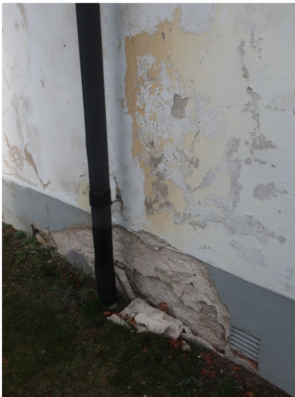
Figur 8. Detalj av puts-skador vid ett av stuprören vid den södra fasaden. Foto från sydöst: Daniel Olsson, 2021-10-12.
