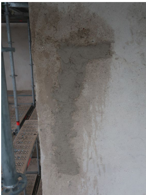
Figur 20. Detalj av lagad spricka på sakristians östra fasad. Foto från öster: Daniel Olsson, 2022-05-25.
