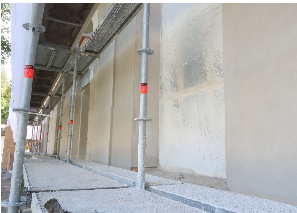
Figur 22. Detalj av långhusets norra fasad efter att ytputsen lagts på. Foto från nordväst, 2022-06-23.
