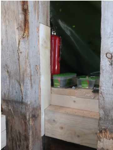
Figur 33. Detalj av lagning av pelare och bjälke under lanterninen. Foto: Daniel Olsson, 2023-05-10.
