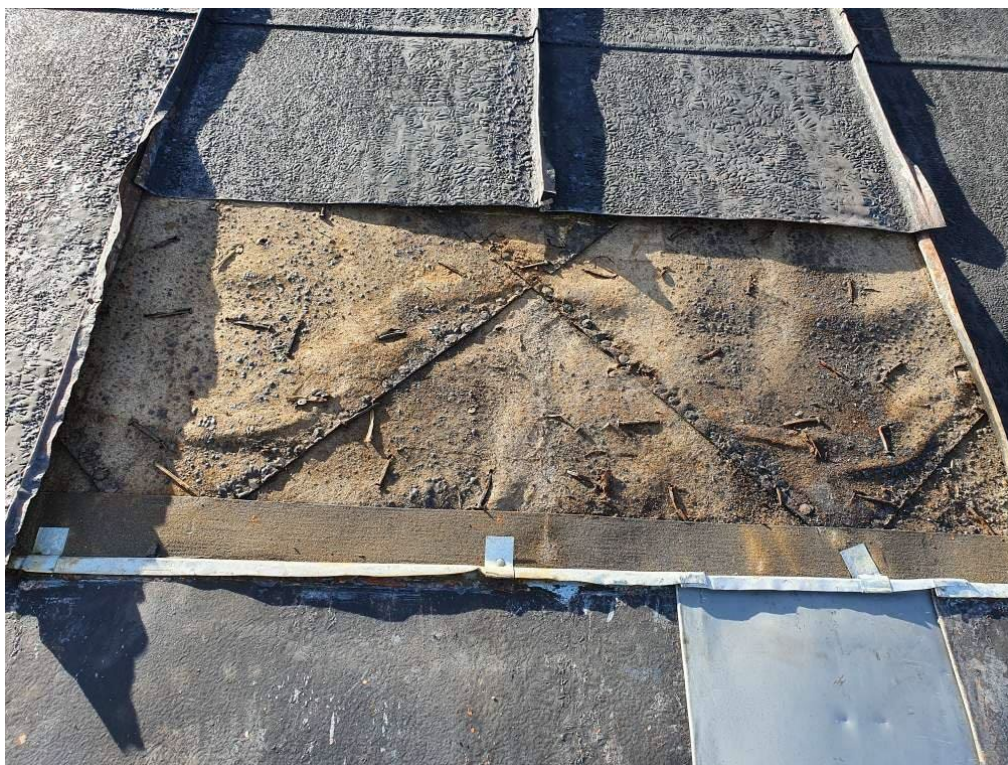
Figur 60. Detalj av det ålderdomliga papptaget som ligger under 1902 års plåttak. Notera de böjda spikarna som troligen blivit kvar som spår från spåntaket kyrkan hade under perioden mellan papptaget och det nuvarande plåttaket. Foto: Lennart Carlsson, våren 2022.
