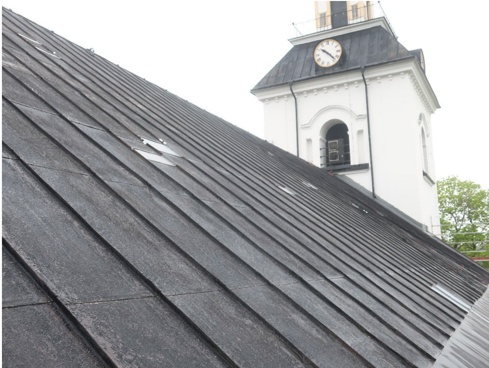
Figur 14. Långhusets takfall mot norr efter att arbetet inleddes. Foto från nordväst: Daniel Olsson, 2022-05-25.
