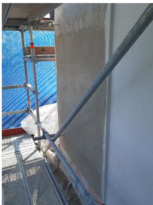
Figur 28. Detalj av ytputs på kyrktornets norra fasad. Foto från nordväst: Daniel Olsson, 2025-05-15.
