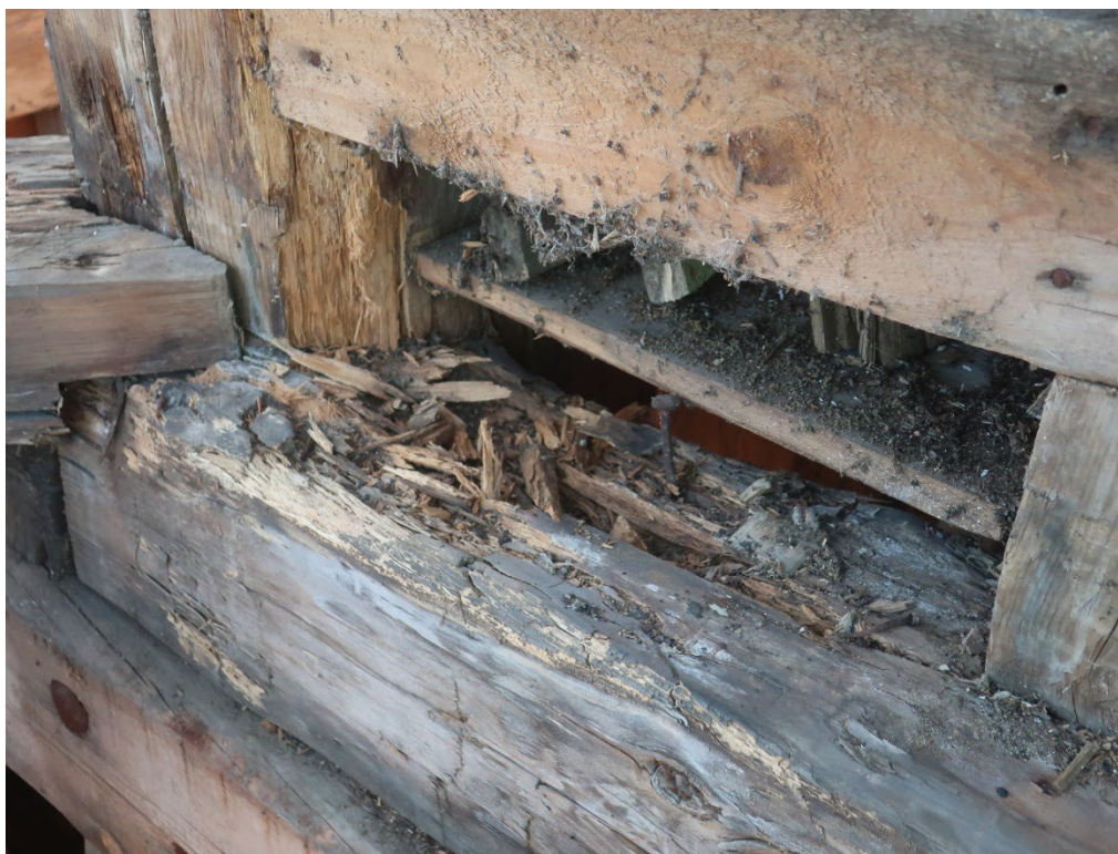
Figur 10. Detalj av rötskadat virke i den bärande konstruktionen under lanterninen. Bilden tagen efter att renoveringens andra etapp hade inletts. Foto: Daniel Olsson, 2023-04-19.
