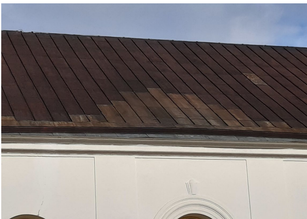
Figur 13. Långhusets takfall mot söder med tidigare utbytt takplåtar där en av kyrkans två takkupor ursprungligen var placerad. Foto från sydväst: Daniel Olsson, 2021-10-12.
