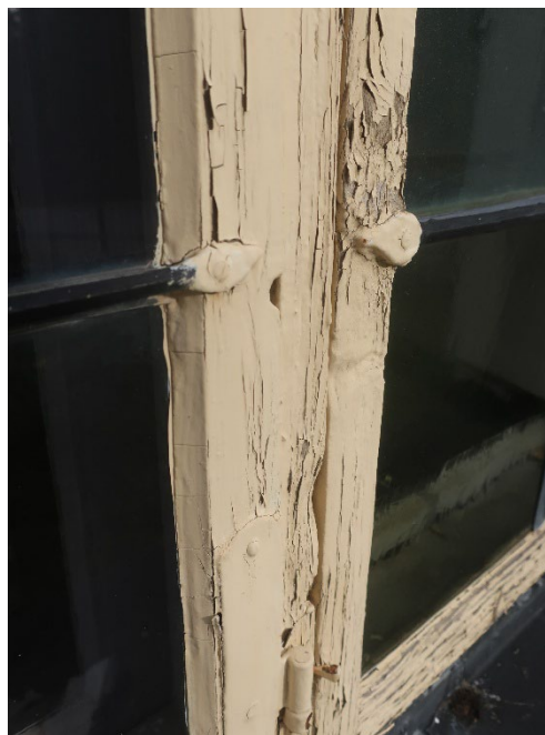
Figur 12. Detalj av fönsterbågar och karm med flagnande färg. Foto: Daniel Olsson, 2021-10-12.
