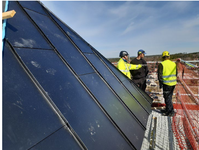
Figur 46. Detalj av ett av lanterninens takfall med ny plåt. Foto: Daniel Olsson, 2023-05-19.
