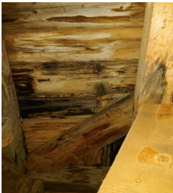
Figur 9. Detalj av fukt- och mögelskador i golvet under lanterninen. Foto: Lennart Carlsson, 2021.
