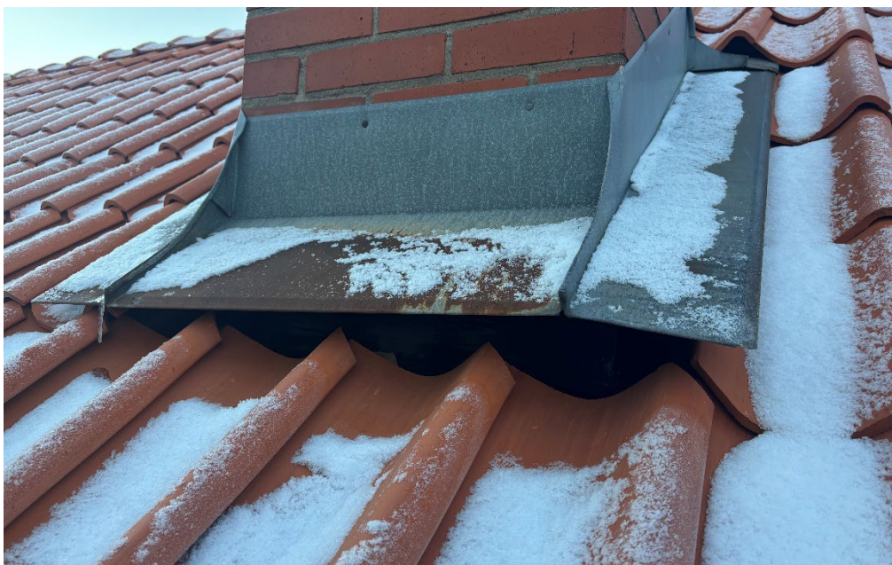
Figur 20. Efter avslutade arbeten. Inga arbeten har skett med skorstensbeslagningen. Vid slutbesiktningen kunde konstateras ett relativt stort mellanrum mellan beslagning och tegeltäckningen. Foto: Ulrika Olsson, 2026-02-02.
