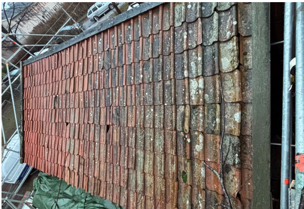
Figur 6. Det västra takfallet på fiskeboden innan påbörjade arbeten. Foto: Ulrika Olsson, 2025-12-07.
