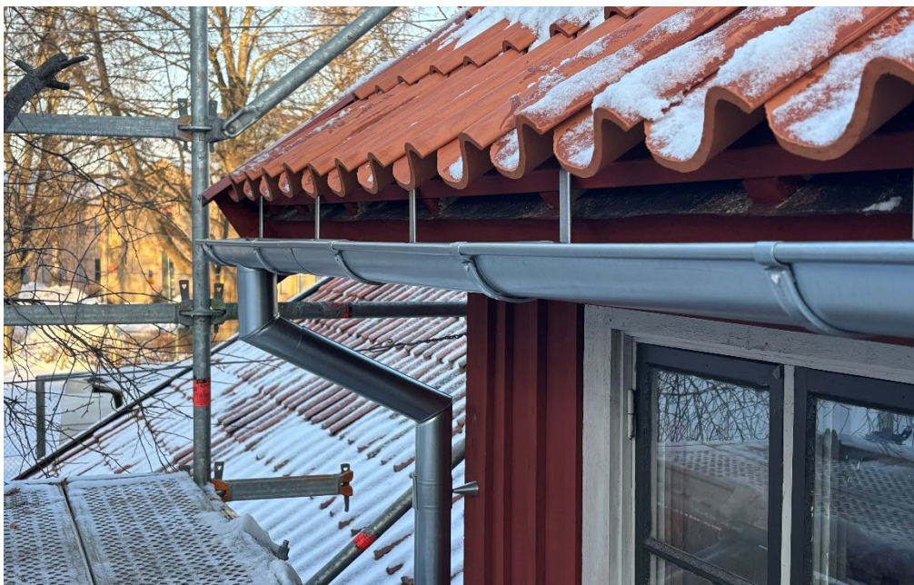
Figur 14. Efter avslutade arbeten. Vid slutbesiktningen pågick montage av nya hängrännor och stuprör i galvaniserad plåt på bostadsdelen. Foto: Ulrika Olsson, 2026-02-02.
