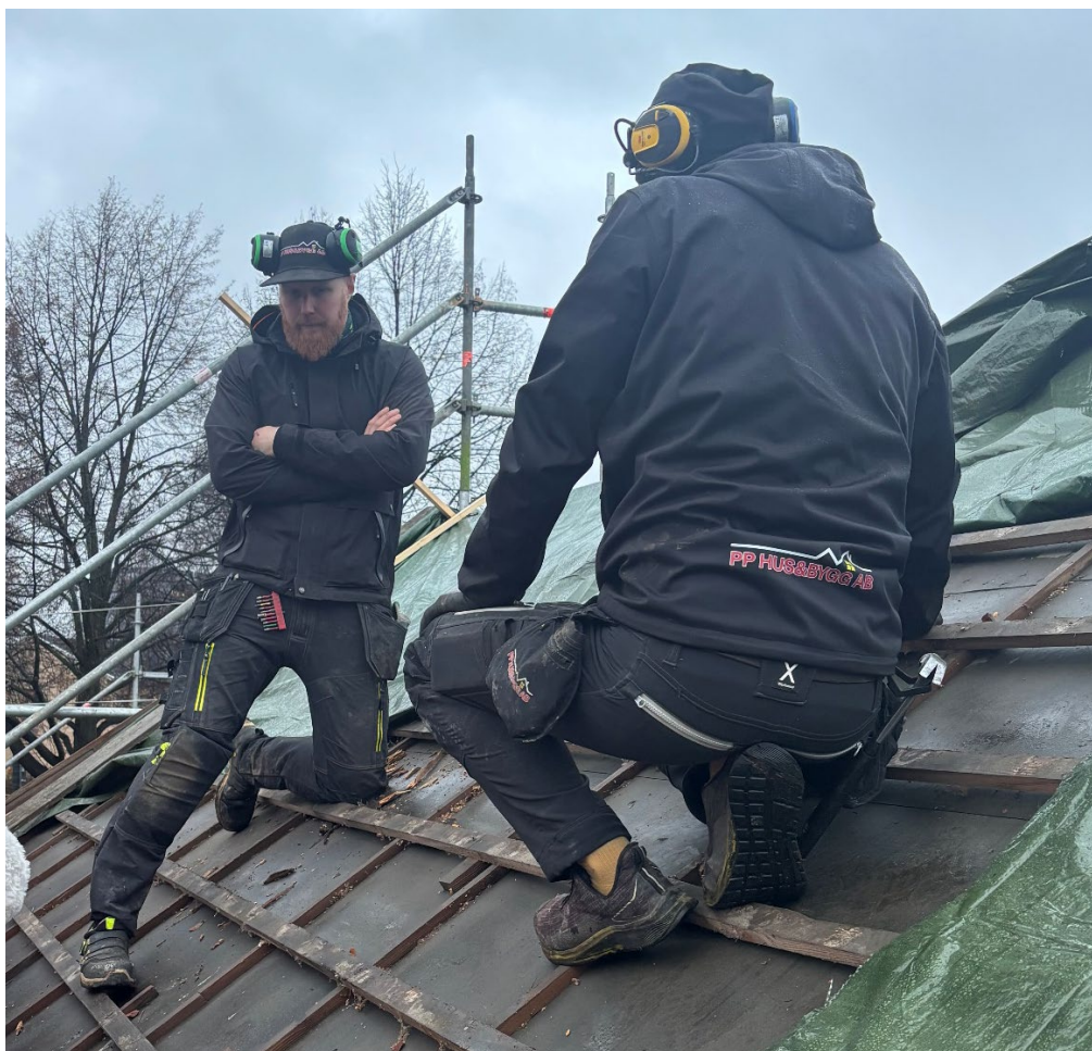
Figur 8. Under demonteringen av det tidigare taket på högdelens upptäckte snickarna från PP Hus & Bygg AB kraftiga rötskador i takkonstruktionen. Skadorna var orsakade av avsaknad av luftspalt i konstruktionen. Foto: Ulrika Olsson, 2025-12-07.
