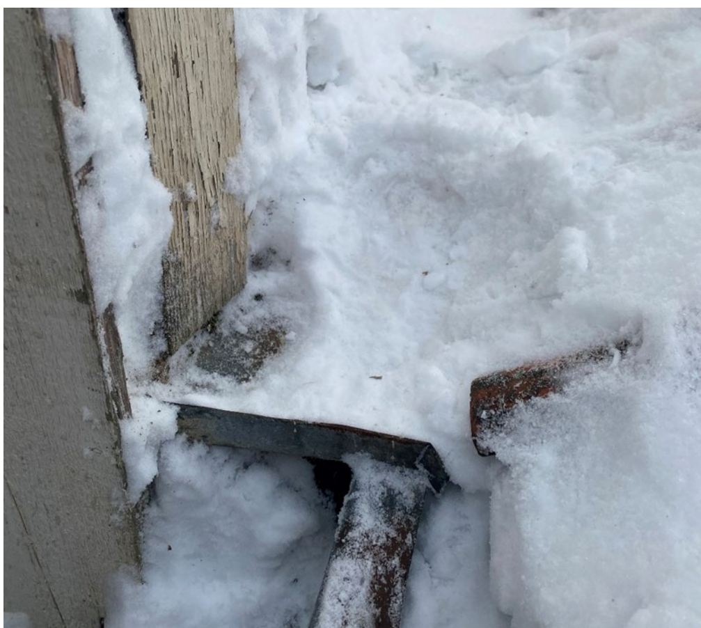
Figur 7. Innan påbörjade arbeten. Det östra takfallet på lågdelen dockar direkt mot fasaden på Springer 3. Den tidigare plåtbeslagningen ansas under snön. Undermålig konstruktion hade gett upphov till läckage in till grannfastigheten, kvarteret Springer 3. Foto: Ulrika Olsson, 2026-01-13.
