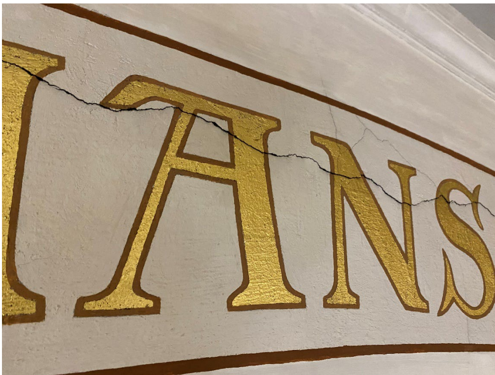
Figur 18. Detalj av den kraftiga sprickan som löpte horisontellt genom delar av inskriptionen i valvbågen. Foto: Ulrika Olsson, 2025-01-20.
