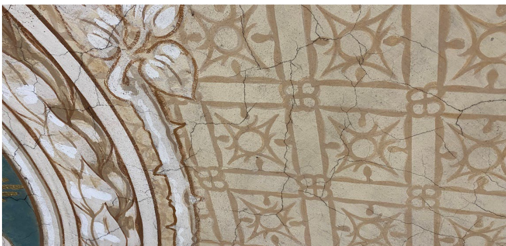
Figur 30. Exempel på microsprickor som finns i putsen i korvalvet. Inga åtgärder är utförda på dessa sprickor. Foto: Ulrika Olsson, 2025-03-27.
