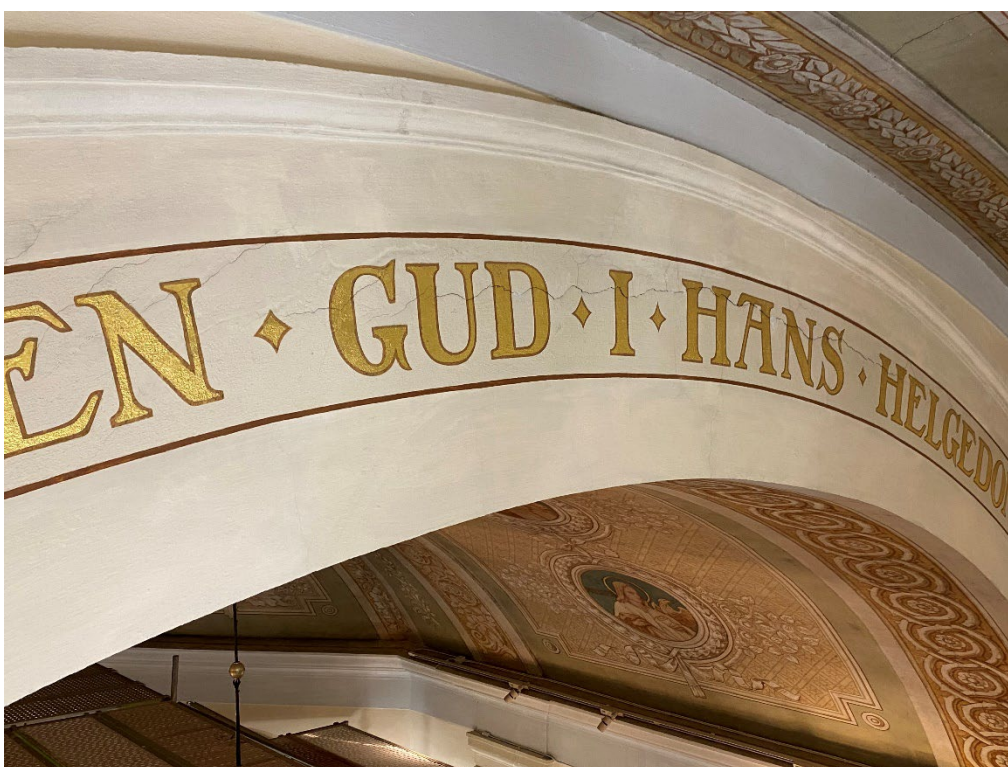
Figur 17. En kraftig spricka löpte horisontellt genom delar av inskriptionen i valvbågen. Foto: Ulrika Olsson, 2025-01-28.
