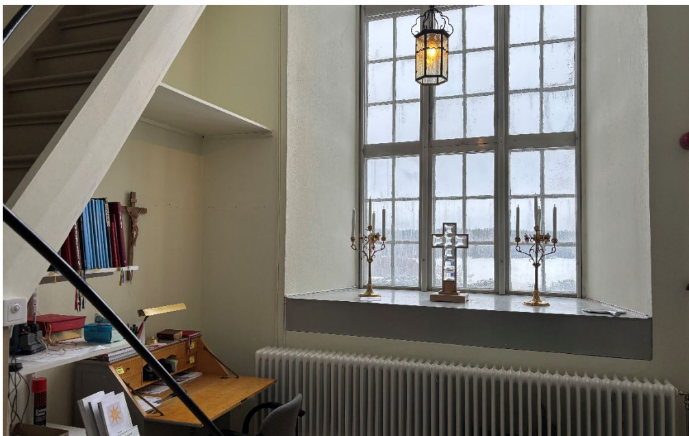
Figur 36. Sakristian efter avslutade arbeten. Väggarna och fönsternischen har rengjorts och målats om med matt linoljefärg. Foto: Ulrika Olsson, 2026-02-11.
