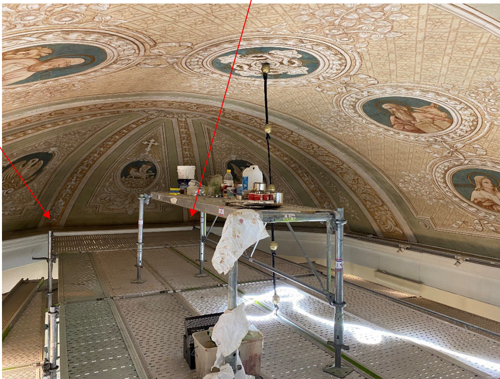
Figur 29. Vid slutbesiktningen 2025-03-27 pågick retuscheringsmålning över lagningar i korvalvet. Lagningar är framför allt utförda längst ner på de dekorativa banden, längst in i valvet, se pilar. Foto: Ulrika Olsson, 2025-03-27.
