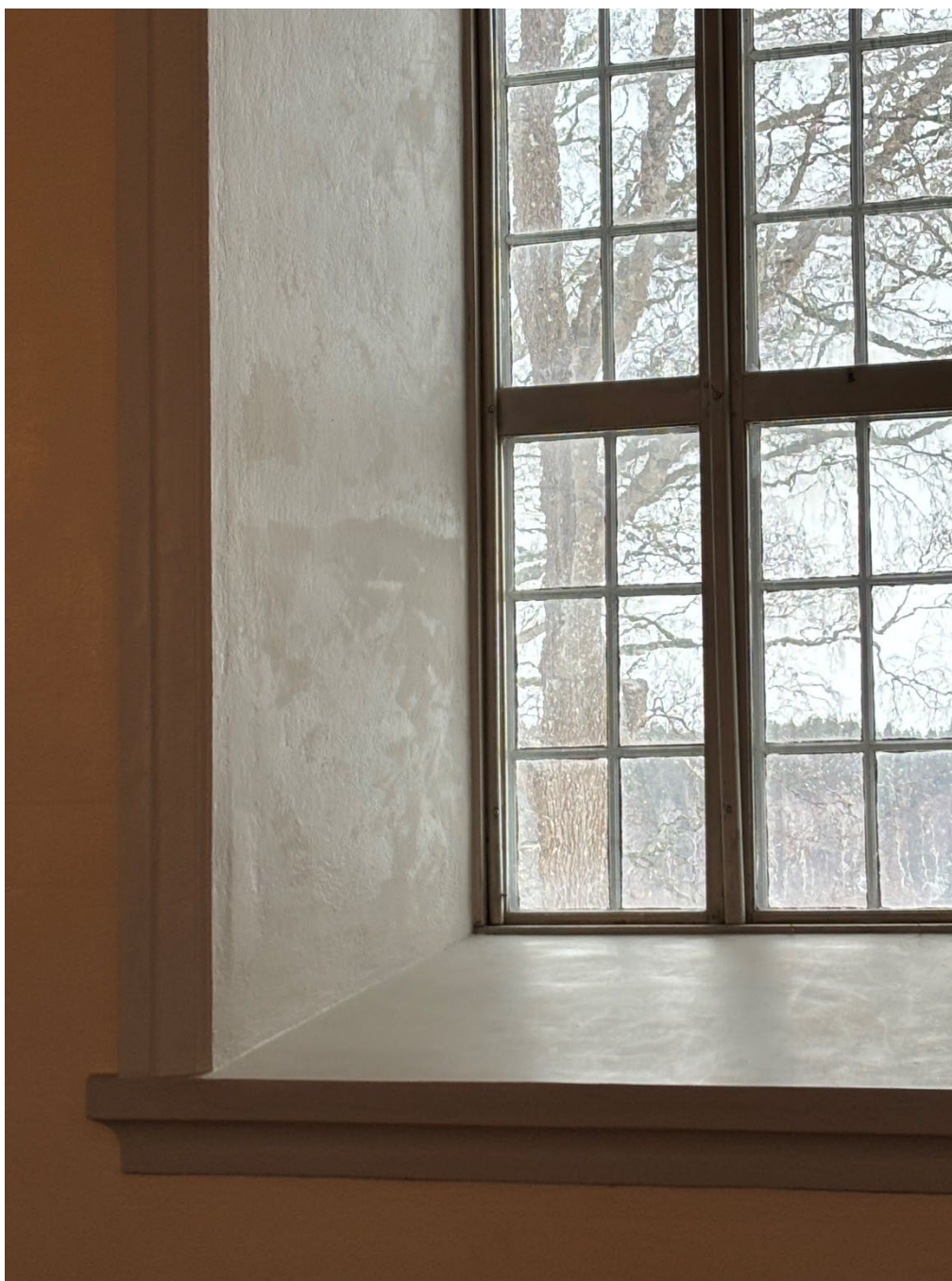
Figur 34. Fönsternischerna har målats om. Efter tre strykningar kvarstår dock flammigheten. Foto: Ulrika Olsson, 2026-02-11.
