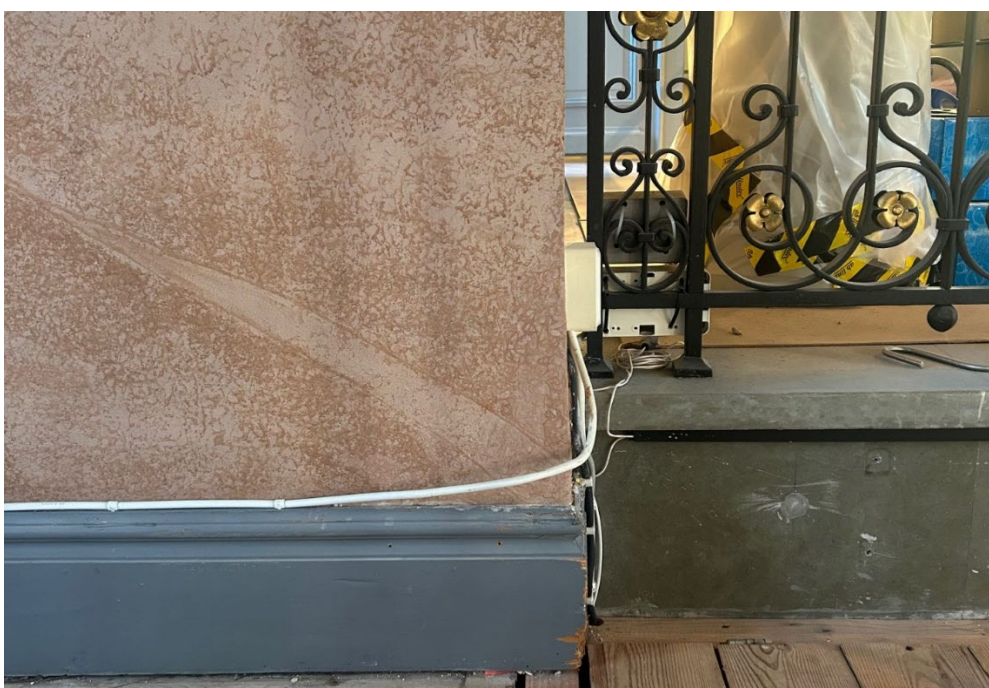
Figur 33. Samma pilaster efter att skadan har retuscherats. Foto: Gästrike Färgverkstad, vintern 2025.
