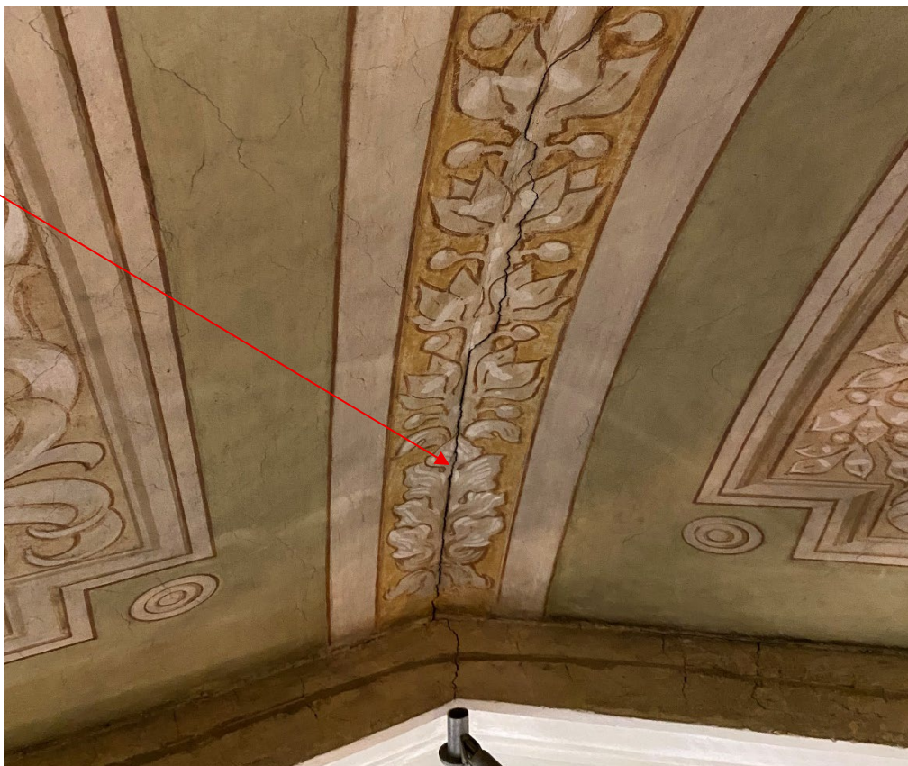
Figur 16. En av de större sprickorna i korvalvet innan påbörjade arbeten. Foto: Ulrika Olsson, 2025-01-20.
