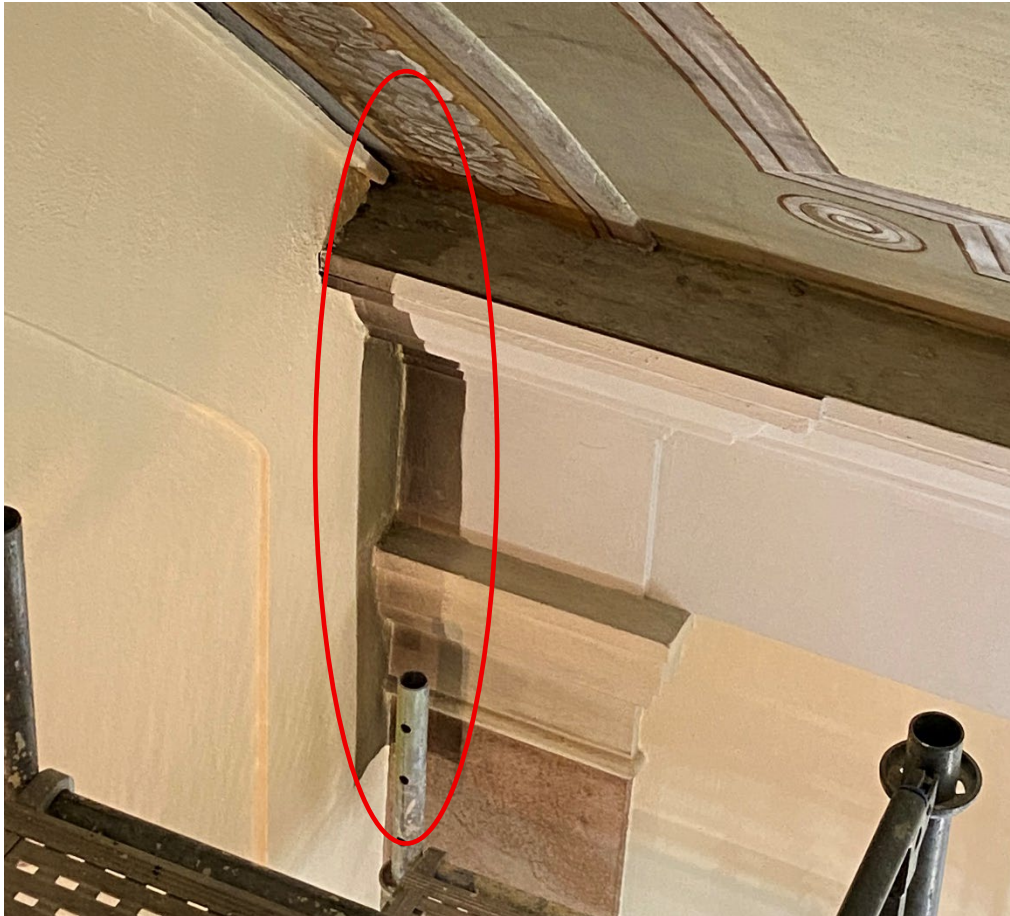
Figur 39. Referensytan i kyrkorummets nordöstra hörn vittnar tydligt om hur hårt smutsade väggarna var innan påbörjade arbeten. Foto: Ulrika Olsson, 2025-03-27.
