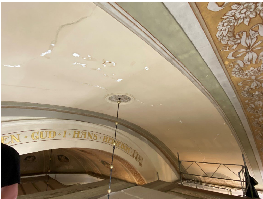
Figur 14. Det gula valvfältet närmast koret var i sämst skick av samtliga valvfält. Foto: Ulrika Olsson, 2025-01-20.
