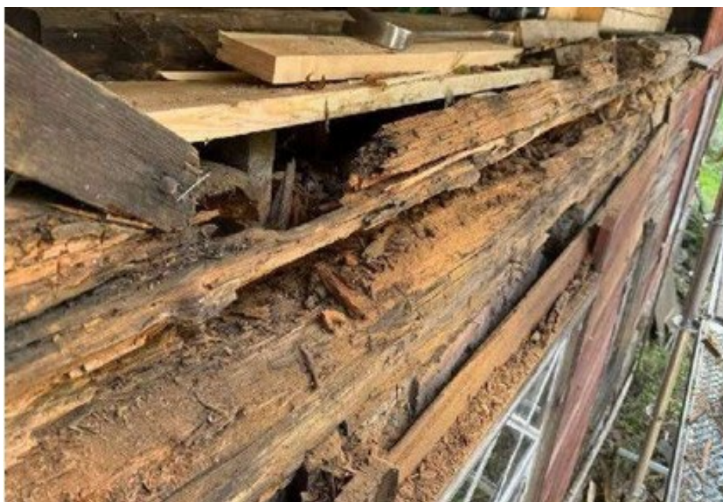
Figur 7. Kraftiga rötskador i den västra väggen på smedjan. Dessa skador uppdagades då den nya entreprenören hade anlitats hösten 2025. Foto: Gustav Lilljeby, 2025-09-30.
