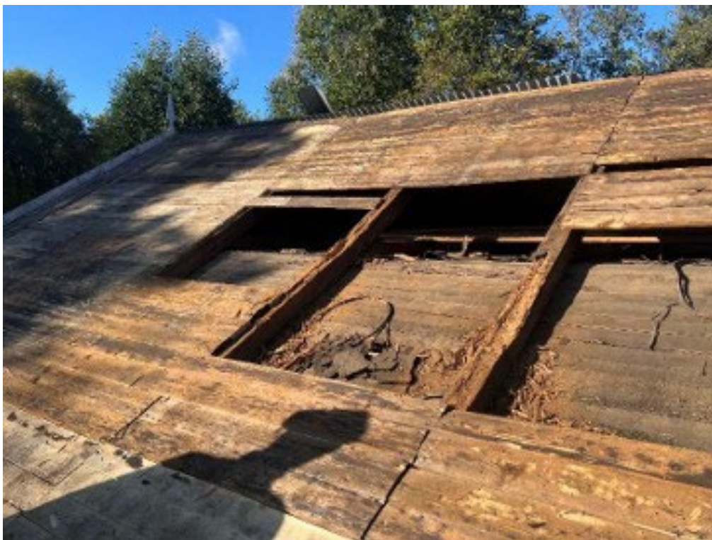
Figur 6. Under pågående återställningsarbeten hösten 2025. Då den felaktiga plåten och den felaktigt lagda pappen hade rivits bort blottades kraftiga rötskador i både råspont och takbjälkar. Foto: Stéphanie Forsmark, 2025-09-30.
