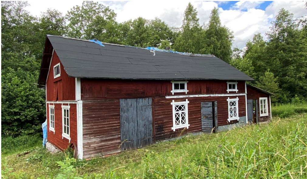
Figur 4. Innan påbörjade arbeten. Byggnaden sedd från sydöst. Taken skyddades av papp och en presenning. Notera svackor i takfallet. Den högre byggnadskroppen rymmer mekanisk verkstad och smedja och den lägre tillbyggnaden rymmer skostall och tvättstuga. Foto: Ulrika Olsson, 2024-07-05.
