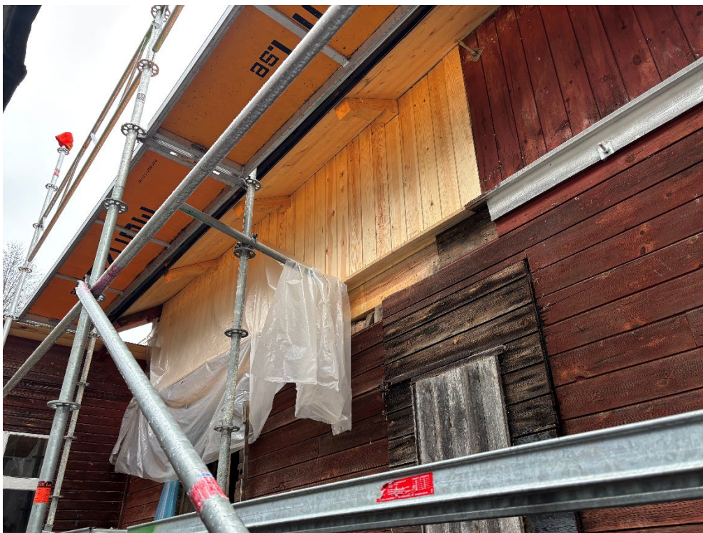
Figur 16. Vid slutbesiktningen 2025-10-28 var den nya panelen monterad på smedjans västra sida. Den underliggande listen var inte åtgärdad. Foto: Ulrika Olsson, 2025-10-28.
