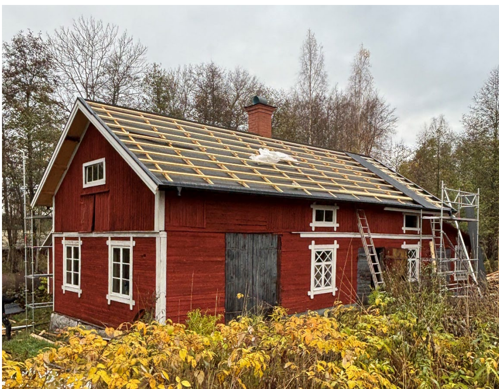
Figur 10. Vid slutbesiktningen 2025-10-28 pågick montering av sinusplåten och detta arbete färdigställdes några dagar senare. På fotografiet syns den nymurade skorstenen samt vindskivor och vindskivebeslag. Foto: Ulrika Olsson, 2025-10-28.
