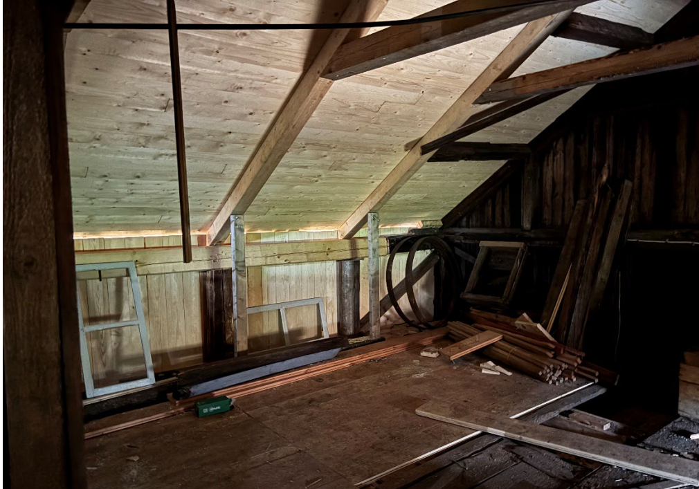
Figur 15. Foto mot den östra långsidan. Tre timmerstockar har lagats i högst upp i väggen. Ny fasadpanel är monterad. Notera även de nya takbjälkarna som syns på fotot. Dessa åtgärdades under 2024 av den första entreprenören. Foto: Ulrika Olsson, 2025-10-28.
