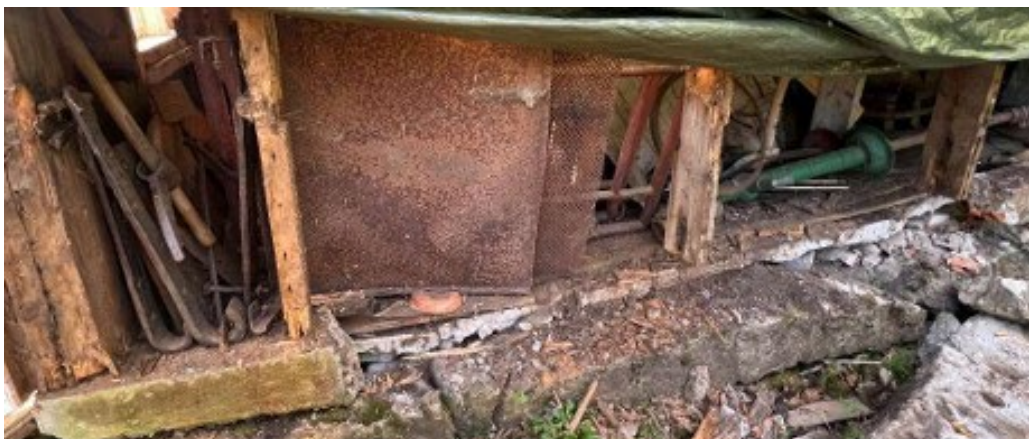
Figur 8. Raserad betongsula på tillbyggnaden samt rötskadade reglar ovanför denna. På fotot är panelen redan bortriven. Foto: Stéphanie Forsmark, 2025-09-30.
