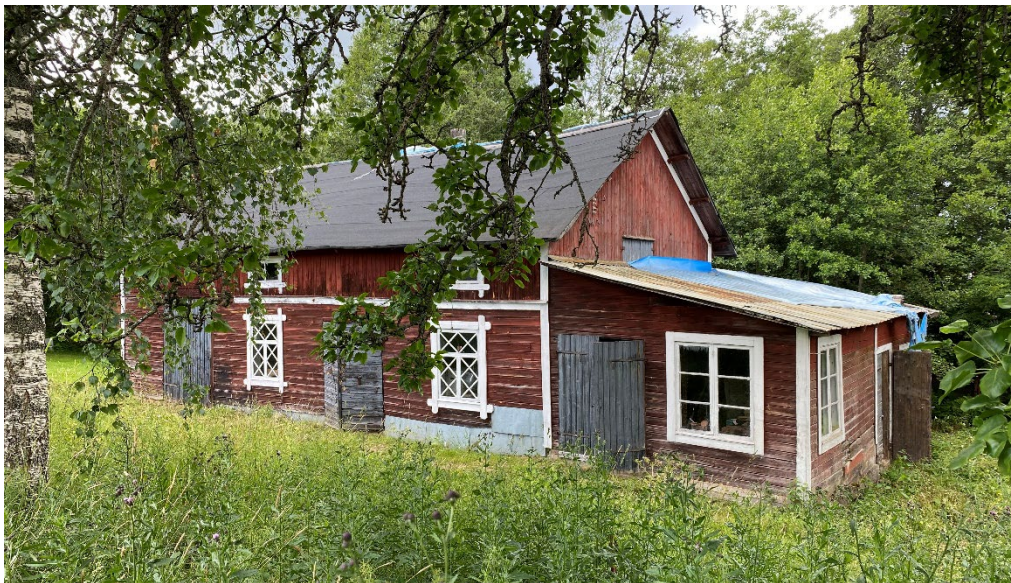
Figur 5. Innan påbörjade arbeten. Byggnaden sedd från nordöst. Taken skyddades delvis av plåt men till största del med papp och en presenning. Foto: Ulrika Olsson, 2024-07-05.
