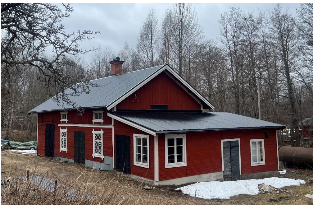
Figur 23. Under slutet av mars 2026 var nästa alla delar färdigställda exteriört. Foder har monterats men ännu återstår montering av stuprör. Foto: Stéphanie Forsmark, 2026-03-24.
