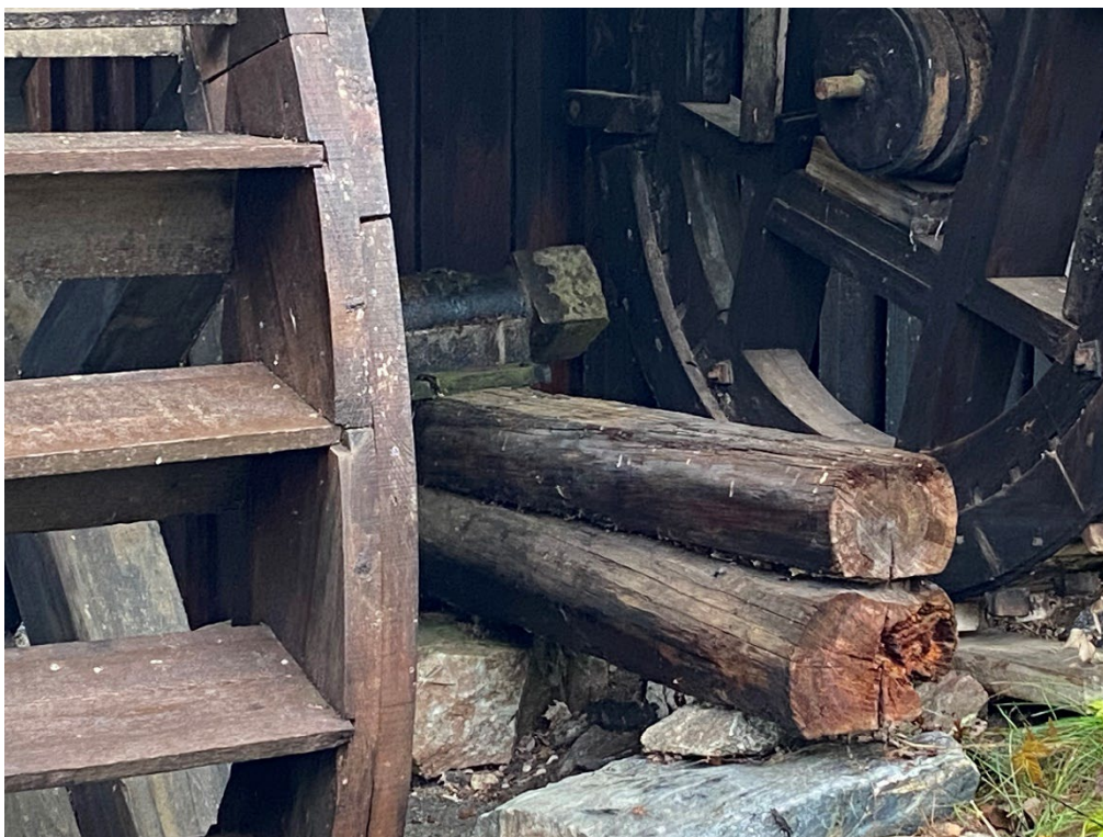
Figur 5. Timret i stödpallarna var till stor del uttjänt. Notera också hjularmarnas konstruktion med dubbelt virke. Foto: Ulrika Olsson, 2023-11-08.
