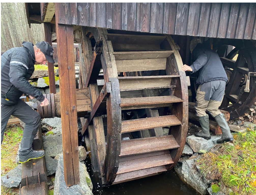
Figur 3. Inför framtagande av åtgärdsförslag och kostnadsberäkning besiktades vattenhjulet. Till vänster syns Martin Karlsson från Lassas Byggnadsvård. Foto: Ulrika Olsson, 2023-11-08.
