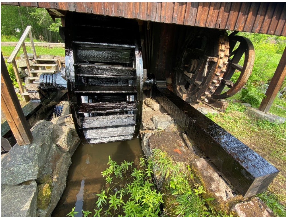
Figur 9. Det färdigrenoverade och justerade vattenhjulet, inklusive de nya stödpallarna. Allt trävirke inklusive smidesdelar har behandlats med varm trätjära. Foto: Ulrika Olsson, 2025-06-10.
