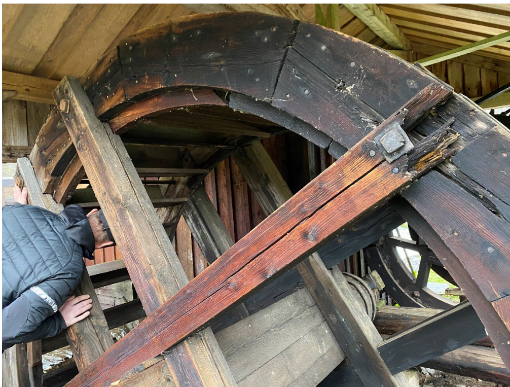
Figur 2. Inför framtagande av åtgärdsförslag och kostnadsberäkning besiktades vattenhjulet. Här syns rötskador i ekrarna tydligt. Foto: Ulrika Olsson, 2023-11-08.
