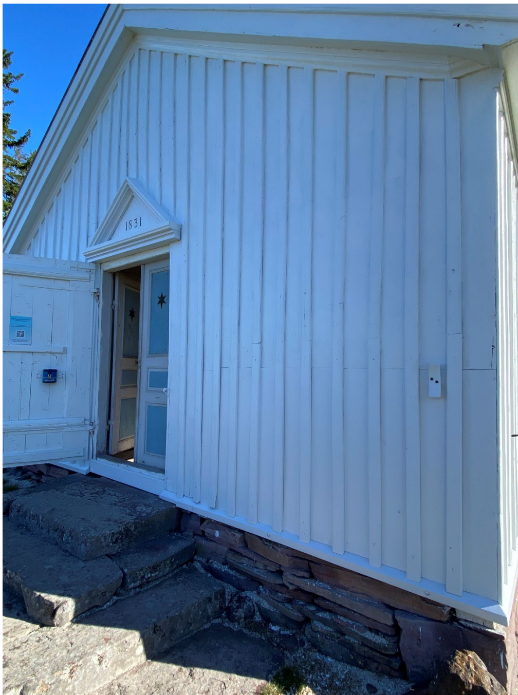
Figur 14. Entrégaveln efter avslutade arbeten. Förutom den iskarvade panelen till höger om ytteddörren så har även offerbrädorna både på denna sida och den södra sidan (till höger i bild) skarvats i med nytt virke. Foto: Ulrika Olsson, 2025-09-22.
