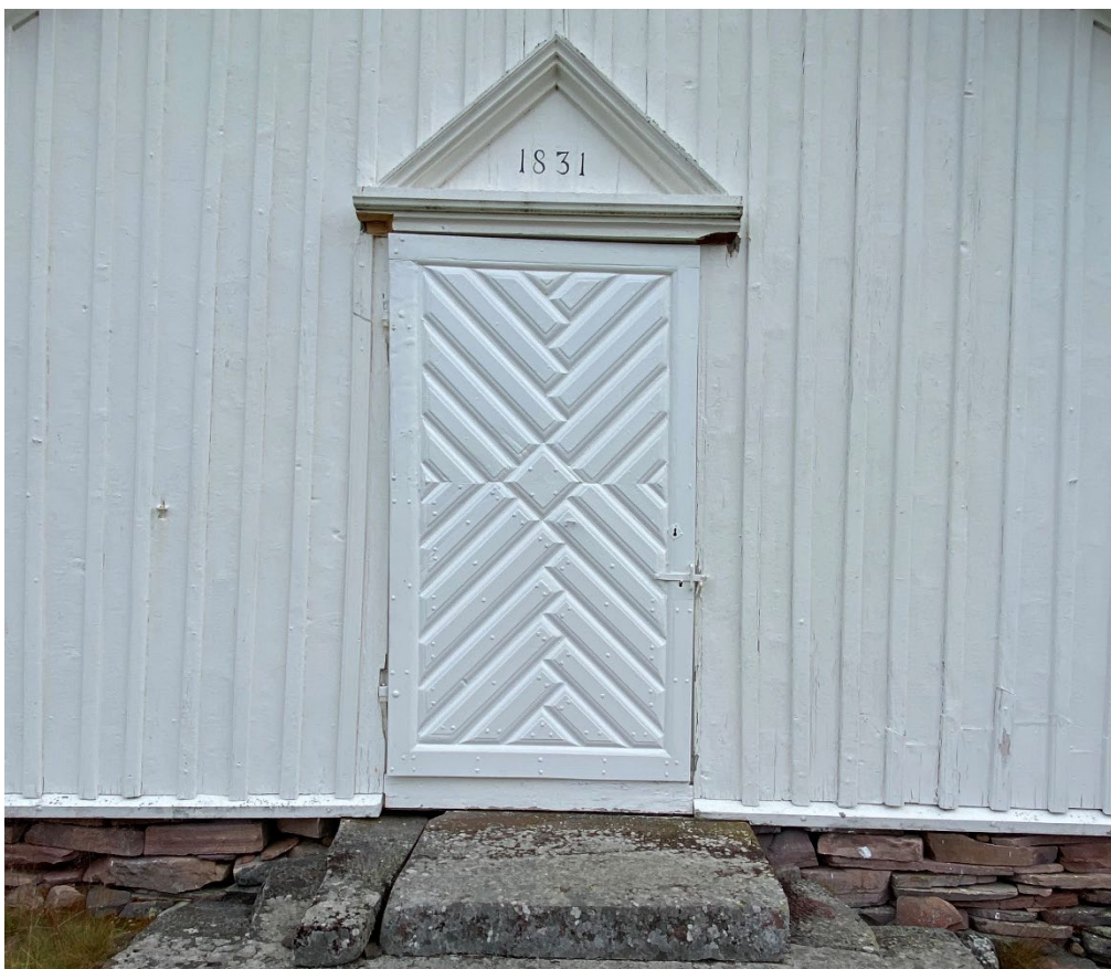
Figur 7. Innan påbörjade arbeten. I samband med att ytterdörren skulle renoveras 2023–2024 så behövde urtag göras i den ovanliggande listen, för att dörren skulle gå att hänga av. Till höger syns även en rötskada som fanns i listen. Foto: Ulrika Olsson, 2024-07-05.
