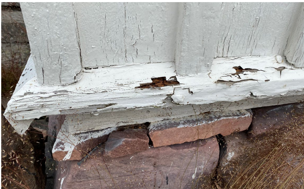
Figur 3. Innan påbörjade arbeten. Rötskadad offerbräda på den södra långsidan. Foto: Ulrika Olsson, 2024-07-05.
