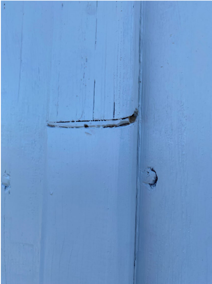
Figur 18. Efter avslutade arbeten. På entrégaveln har panelen lagats i med ny panel. I detta möte mellan gammal och ny locklist har en listen skärva av trä tryckts in. Utförandet är inte godkänt och behöver göras om. Foto: Ulrika Olsson, 2025-09-22.
