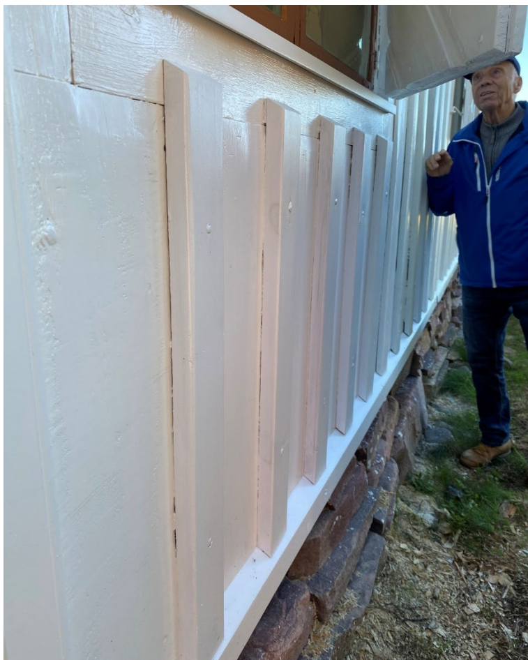
Figur 20. Locklisterna under det östra fönstret på den norra gaveln är för klumpiga, både sett till bredd och tjocklek. Dessutom saknar de en profil i kanterna. Foto: Ulrika Olsson, 2025-09-22.
