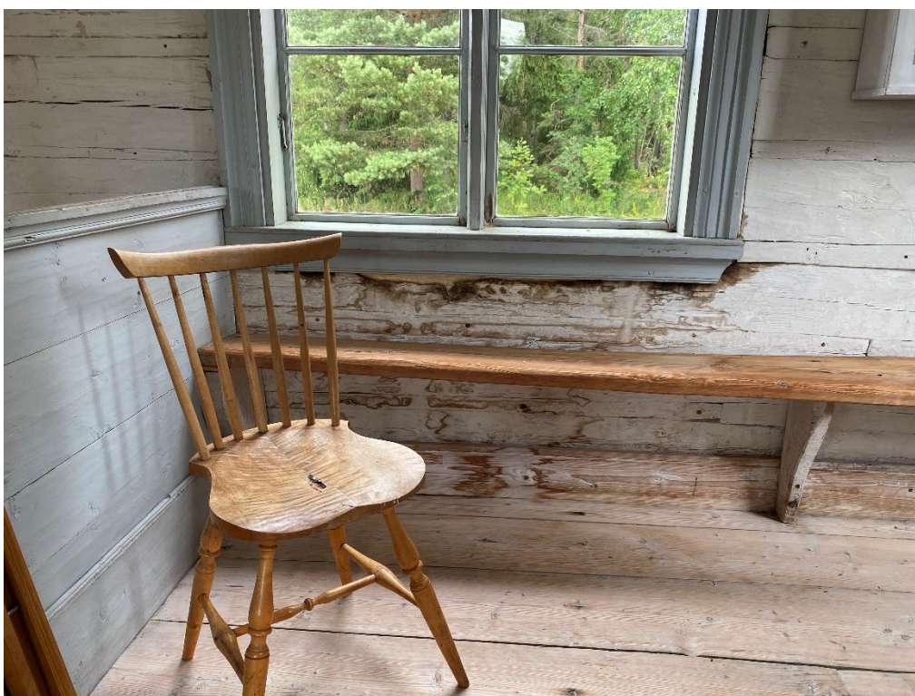
Figur 6. Innan påbörjade arbeten fanns svampangrepp och rötskador kring och under det östra fönstret på den norra sidan. Foto: Ulrika Olsson, 224-07-05.
