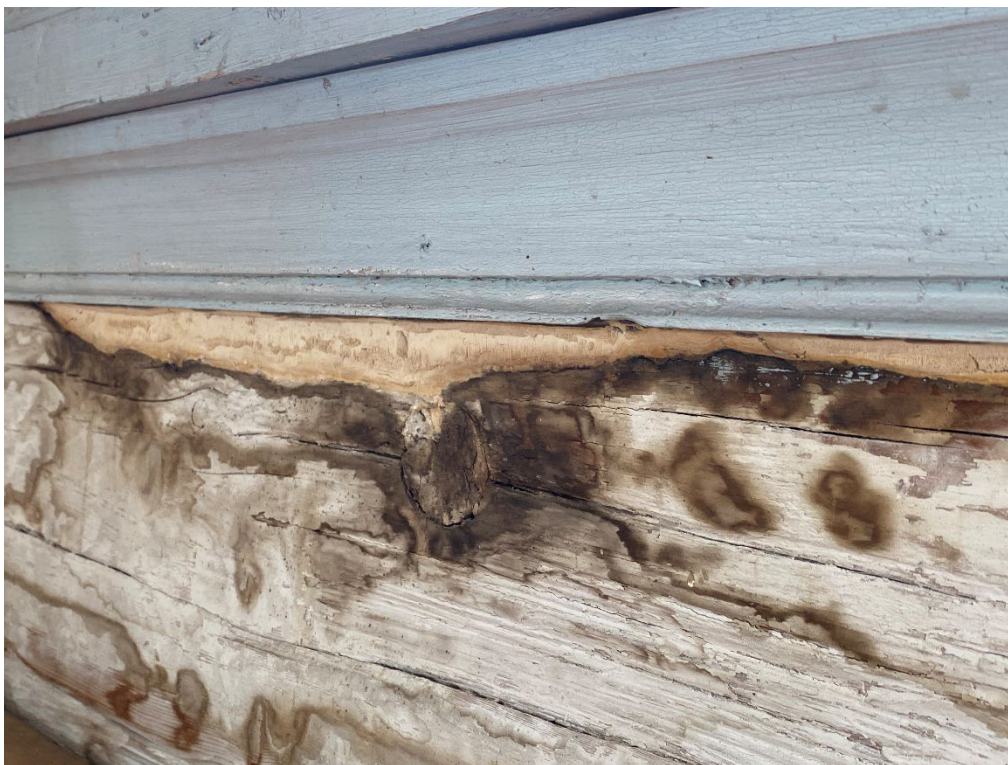
Figur 5. Innan påbörjade arbeten. Detalj av de rötskador som fanns kring det östra fönstret utefter den norra sidan, inne i kapellet. Foto: Ulrika Olsson, 2024-07-05.
