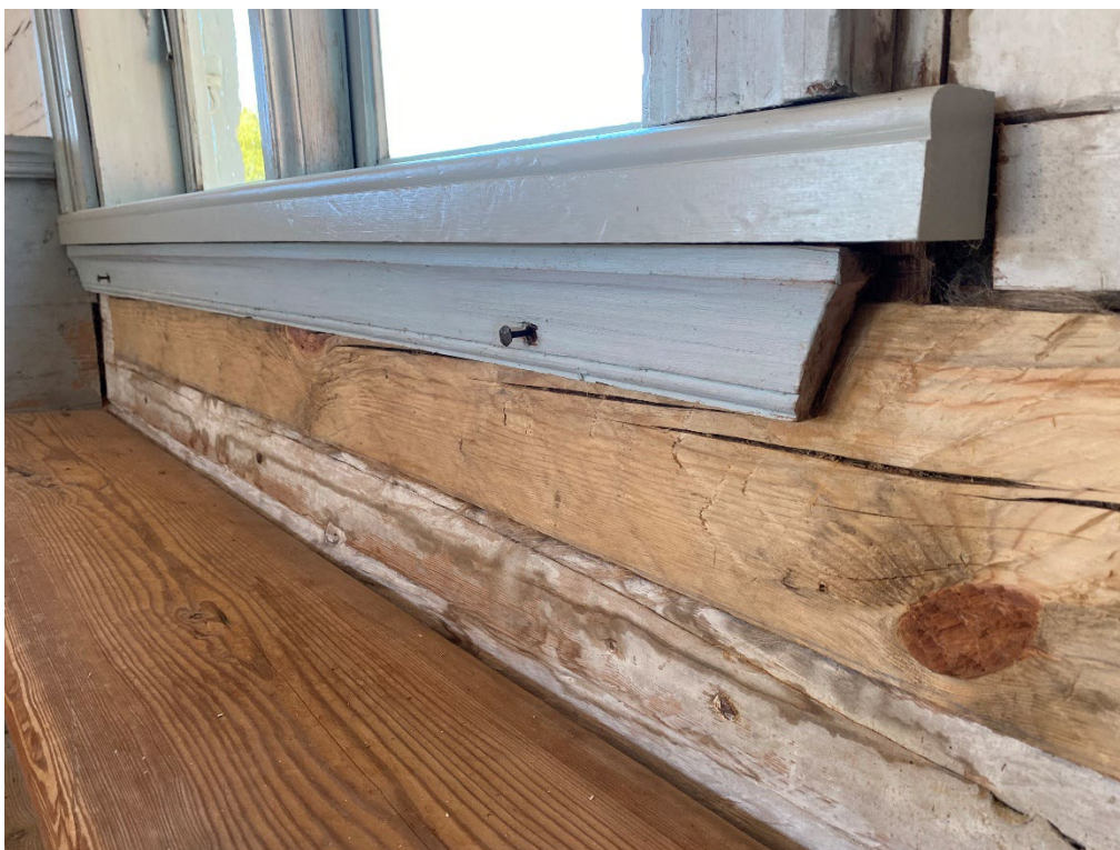
Figur 11. Efter avslutade arbeten. Det rötskadade virket kring det östra fönstret på den norra fasaden har lagats i med nytt virke och fönsterbrädan är nytillverkad. Dock ska den avslutas i linje med fönsterfodret, jämför med utformningen innan påbörjade arbeten, figur 4. Kulören på de nya gråblå delarna är frambruten på plats. Foto: Ulrika Olsson, 2025-09-22.
