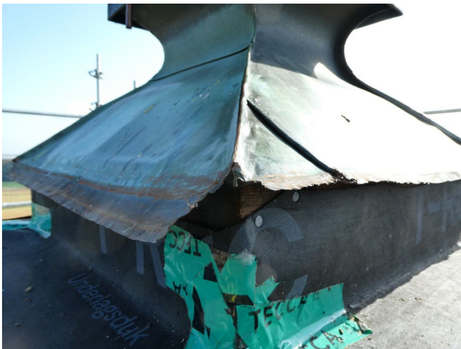
Figur 12. Under pågående arbeten med plåtläggning på lanterninhuven. Underlagspappen är uppdragen mot tornkorsets fot. Foto: Mats Jonaeson, 2024-09-06.
