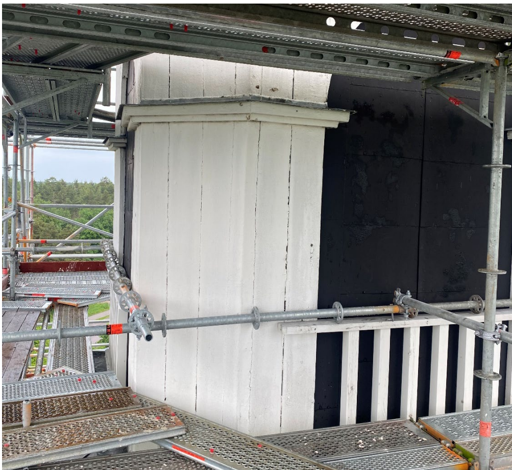
Figur 8. Lanterninens träpanel stod inte längre emot kraftiga regnoväder. Vatten trängde in genom mellanrum i träpanelen. Foto: Ulrika Olsson, 2024-06-03.
