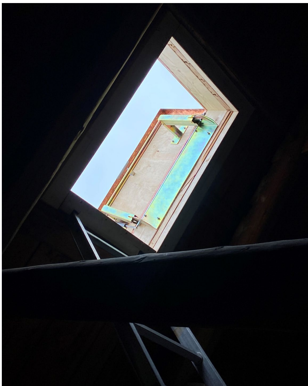
Figur 37. En nytillkommen stege i aluminium leder upp till den nya takluckan. Foto: Ulrika Olsson, 2025-07-03.
