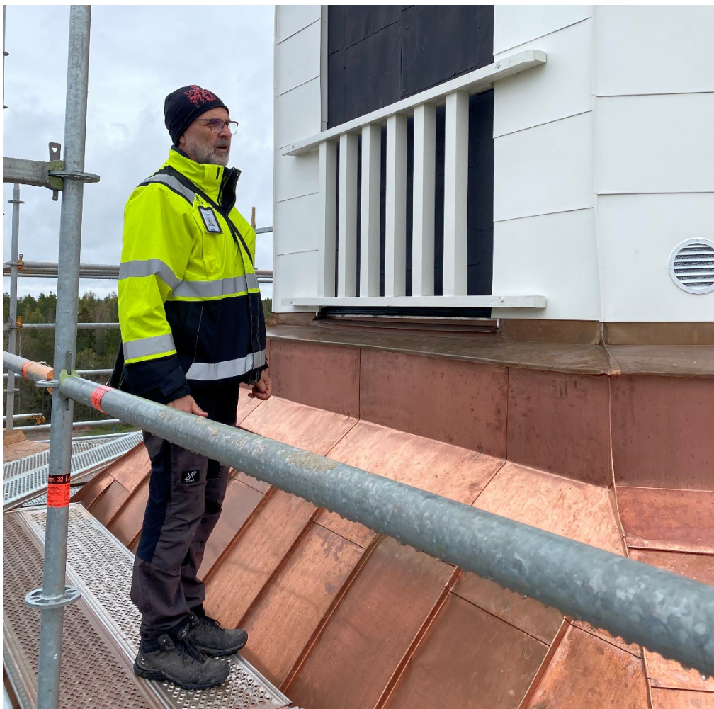
Figur 21. Besiktningsman Mats Jonaeson inspekterar lanterninens sockel vid besiktningen 2025-04-24. Foto: Ulrika Olsson.
