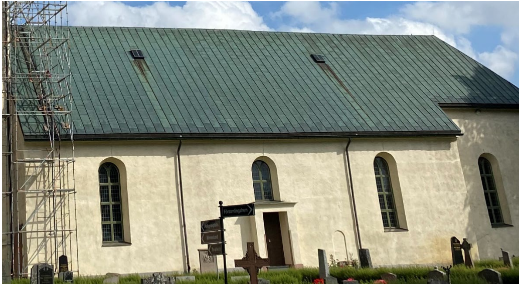
Figur 38. Gångjärn och bygel på de två takluckorna på södra takfallet består av galvat material. Detta orsakar rostrinningar på underliggande plåttäckning. Foto: Ulrika Olsson, 2024-08-21.
