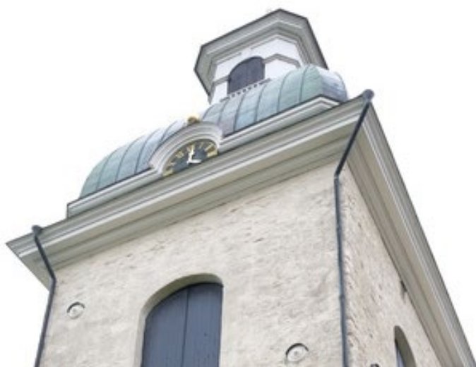
Figur 32. Innan påbörjade arbeten hade stuprörens övre delar olika anslutningar till utkastarna. Foto: Hans-Erik Olsson 2022.
