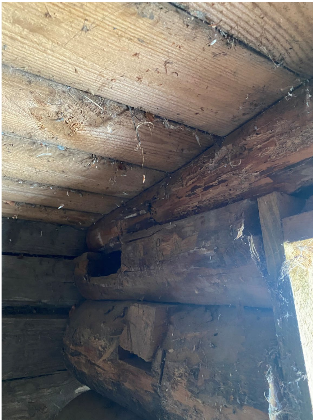
Figur 4. Innan påbörjade arbeten. I anslutning till luckan på brokivistens östra sida, fanns äldre delar bevarade från en tidigare brokista. Martin Karlsson från Lassas Byggnadsvård bedömde att den översta stocken förmodligen kan ha utgjort en del i den ursprungliga eller tidiga brokistan. Foto: Ulrika Olsson, 2025-02-21.
