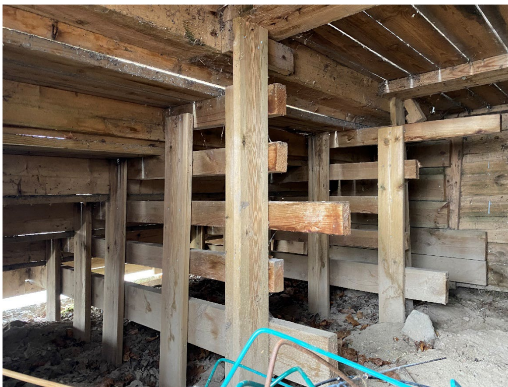
Figur 3. Innan påbörjade arbeten. Brokvistens trappa och broplan vad uppstogade med tryckimpregnerat virke. Foto: Ulrika Olsson, 2025-02-21.
