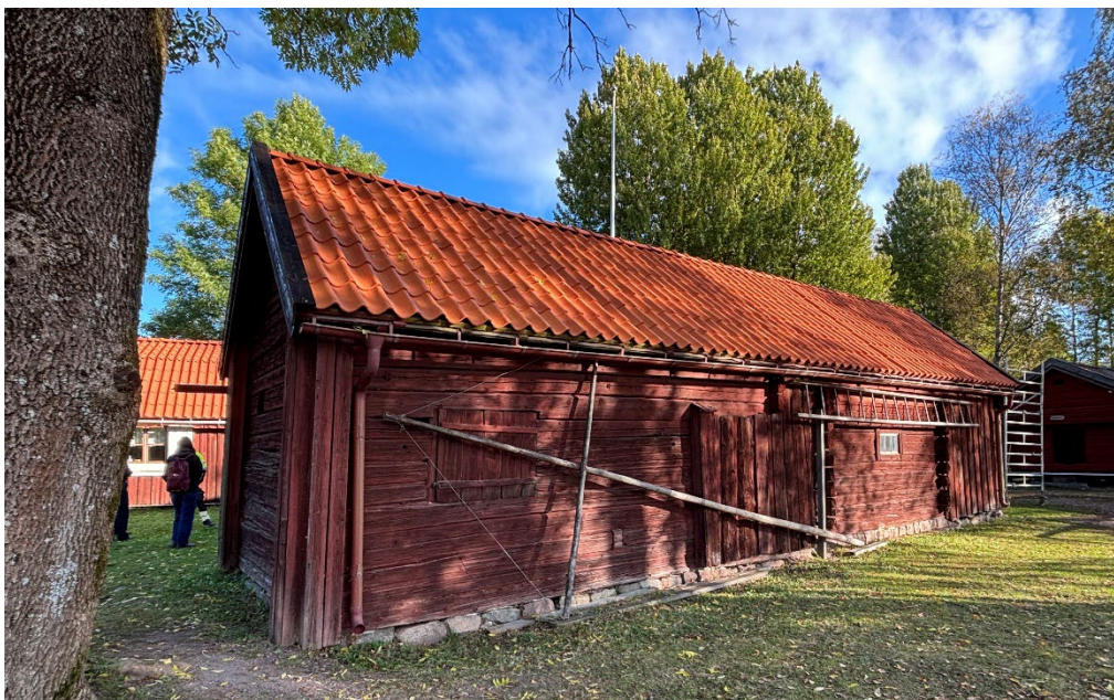
Figur 15. Efter avslutade arbeten. Ladugårdens södra takfall. På denna sida har det gamla stupröret och hängrännorna återanvänts. Till vänster syns den stora asken som växer tätt på byggnaden. Foto: Ulrika Olsson, 2025-09-29.
