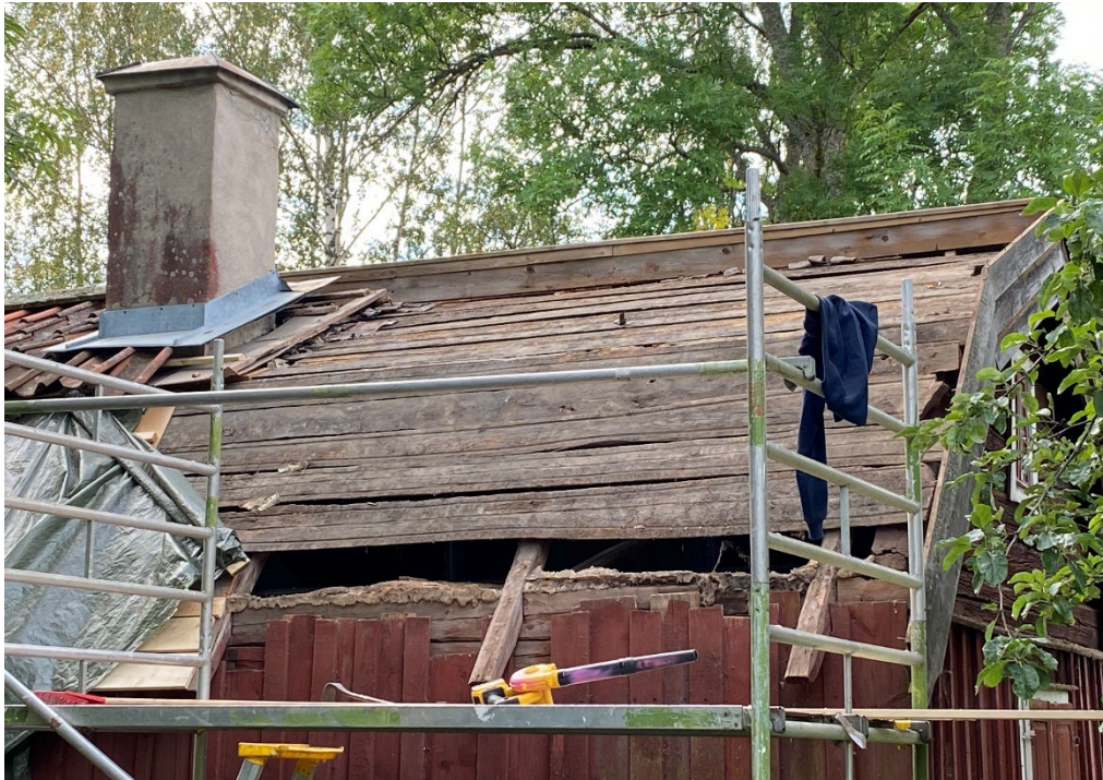
Figur 9. Under pågående arbeten. Tegel, läkt och näver är bortrivet på bostadsdelens norra takfall. Rötskadad takpanel ersätts med nytt virke. Foto: Ulrika Olsson, 2025-09-02.
