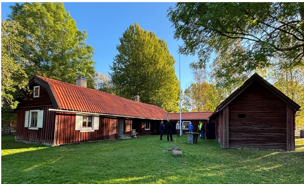
Figur 11. Efter avslutade arbeten. Alla tak är belagda med nytt enkupigt lertegel från Vittinge. Bostadsdelen och ladugårdens insida har fått nya hängrännor i trä. Vindskivor och vattbrädor är nya och tjärstrukna. Foto: Ulrika Olsson, 2025-09-29.
