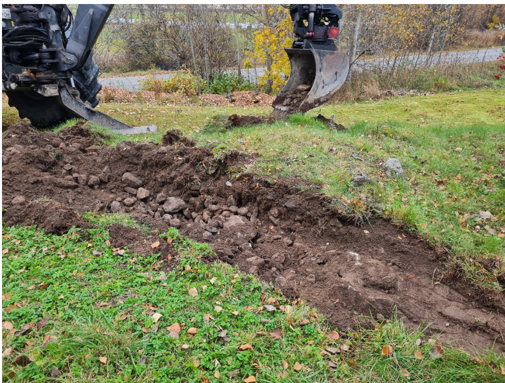
Figur 12. Läge 2. I schakt 17 genom den gravlikande förhöjningen framkom löst liggande stenar hörande till ett röjningsröse L2025:6010. Foto från nordväst: Maria Björck.
