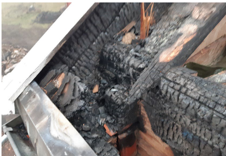
Figur 11. Detalj av brandskada vid det södra takfallets sydvästra del. Foto: Daniel Olsson, 2023-11-07
