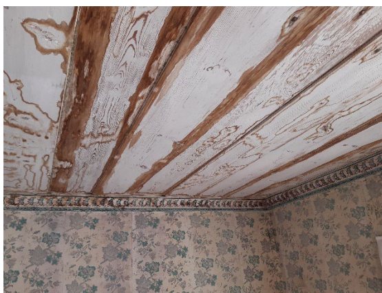
Figur 19. Detalj av innertaket innan renoveringen. Foto: Daniel Olsson, 2024-05-20.
