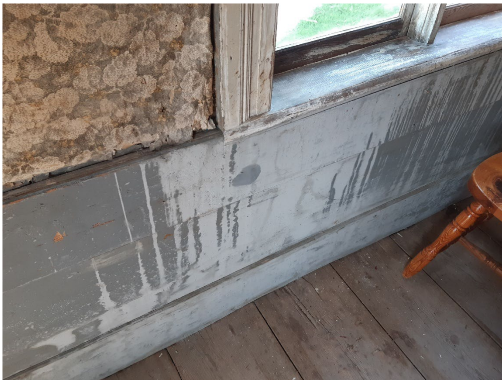
Figur 41. Fuktskador på bröstpanelen mot väster i köket under den övre salens södra del. Foto från sydöst: Daniel Olsson, 2024-05-20.
