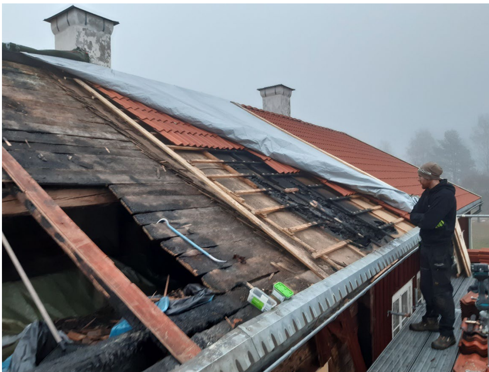
Figur 10. Markus Ståhl intill det södra takfallets brandskadade delar. Foto från sydväst: Daniel Olsson, 2023-10-26.
