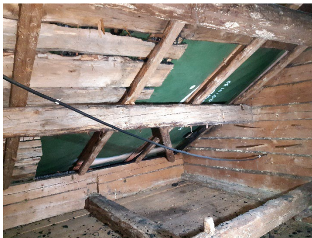
Figur 13. Detalj av skadat parti på vinden under takfallet mot söder intill byggnadens sydvästra hörn efter bortkapning av skadat trovirke. Foto från nordöst: Daniel Olsson, 2023-10-26.
