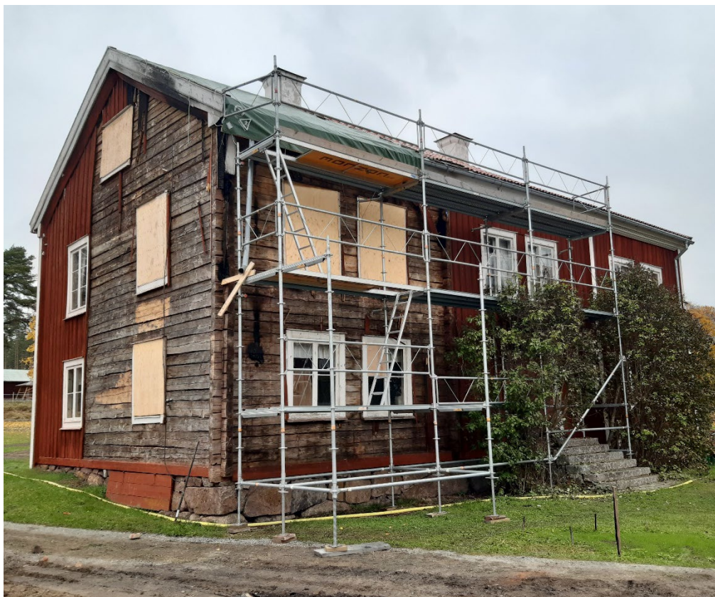
Figur 14. Bröllopsstugan från sydväst med skadad och delvis borttagen panel. Foto: Daniel Olsson, 2023-10-26.
