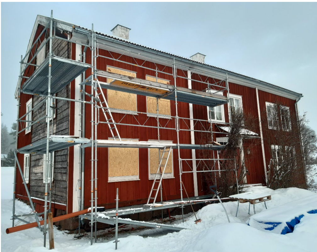
Figur 28. Bröllopsstugan från sydväst efter uppsättning av locklistpanel på den södra fasaden. Foto: Daniel Olsson, 2025-01-28.
