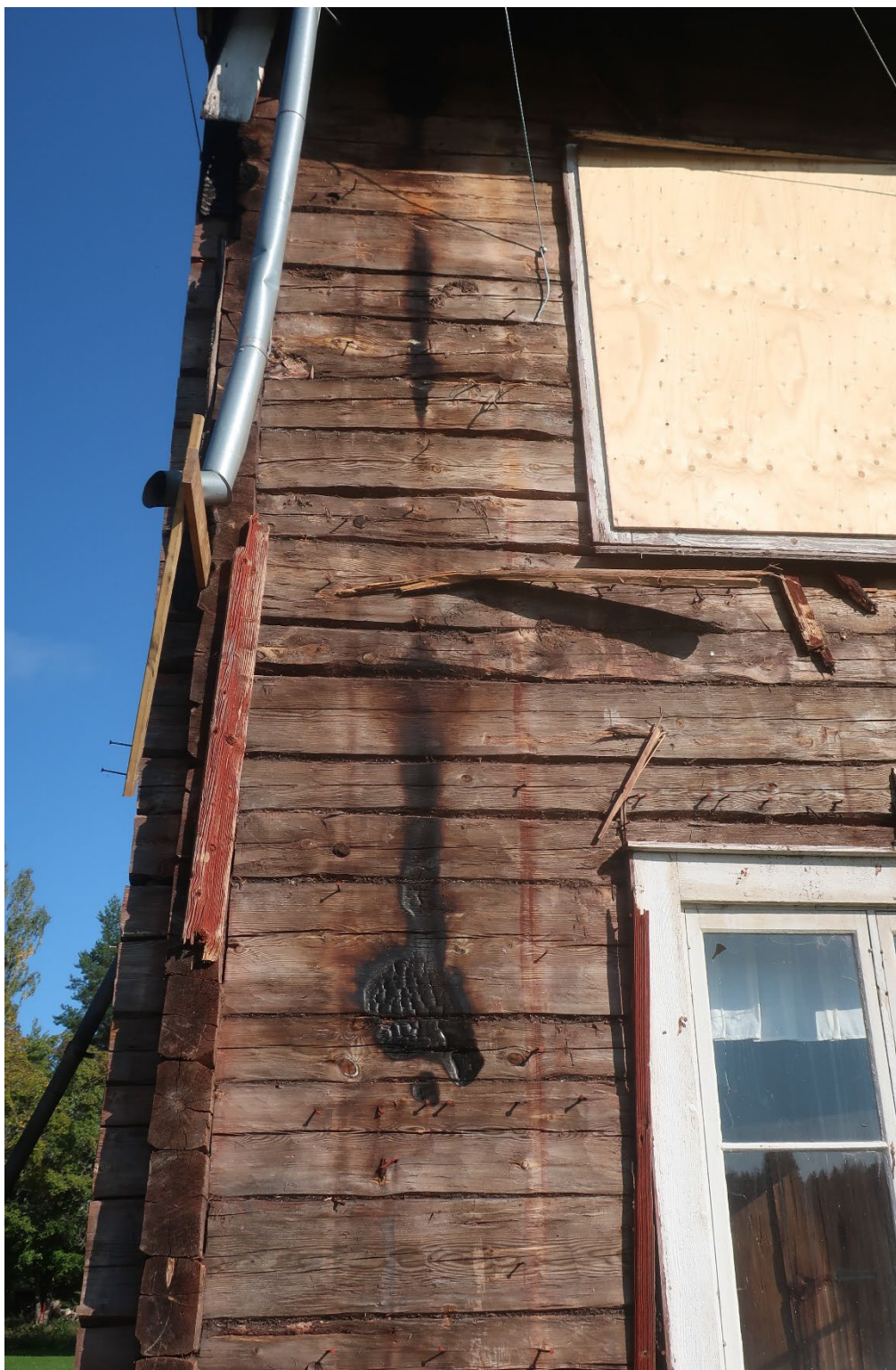
Figur 15. Detalj av brandskada i timmerstommen på den södra fasadens västra del. Foto från söder: Daniel Olsson, 2023-09-11.
