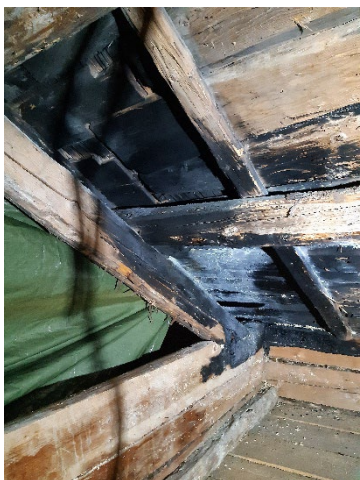
Figur 12. Detalj av brandskada i takkonstruktionen på vinden under det södra takfallet. Foto från nordväst: Daniel Olsson, 2023-10-26.
