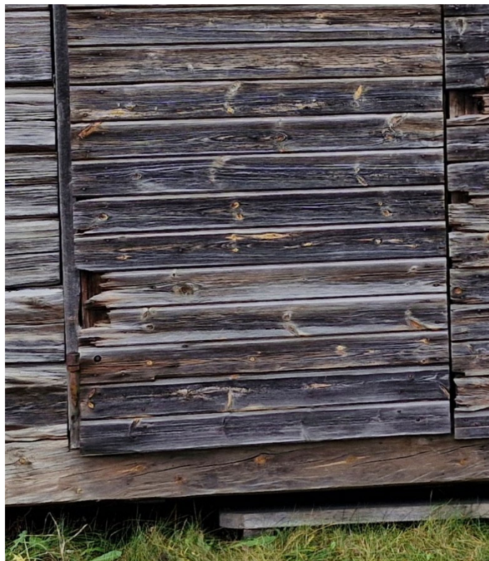
Figur 19. Detalj av port med några skadade panelbrädor, sannolikt på grund av att de har hamnat i kläm mot timret när porten har öppnats helt och hållet. Foto: Daniel Olsson, 2025-11-11.
