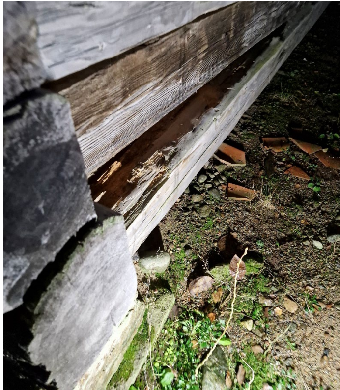
Figur 16. Detalj av rötskadade stockar på baksidan av ett kyrkstill. Foto: Daniel Olsson, 2025-11-04.
