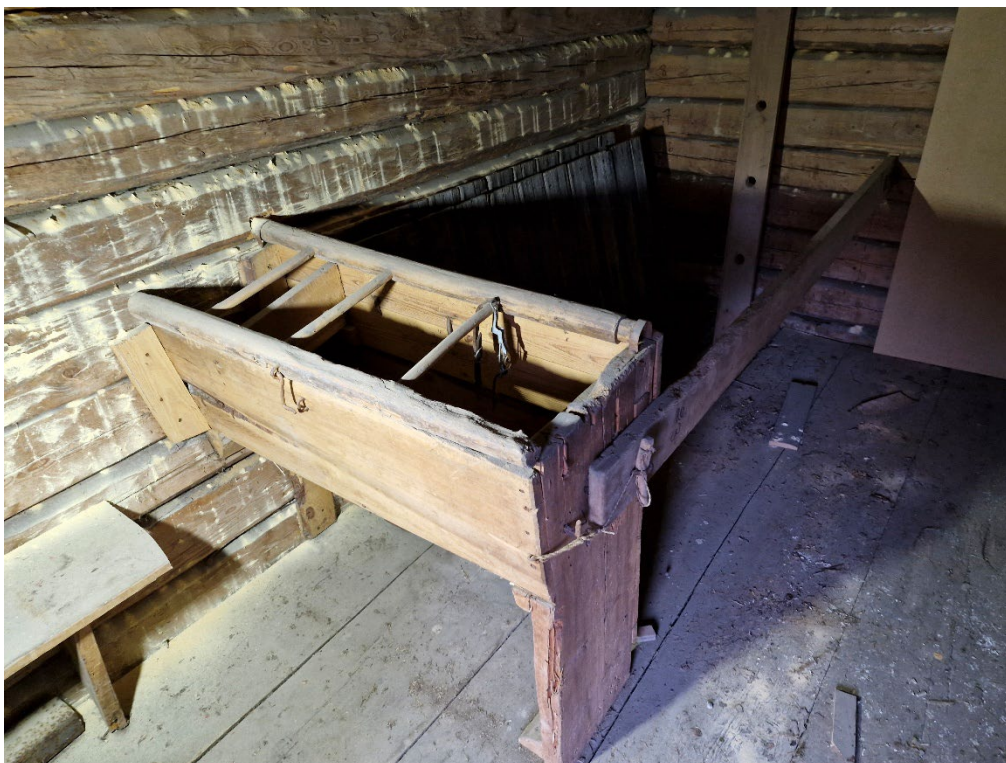
Figur 22. Interiör med mycket spår av trägnagare (träjöl) på väggarna. Foto: Daniel Olsson, 2025-11-11.
