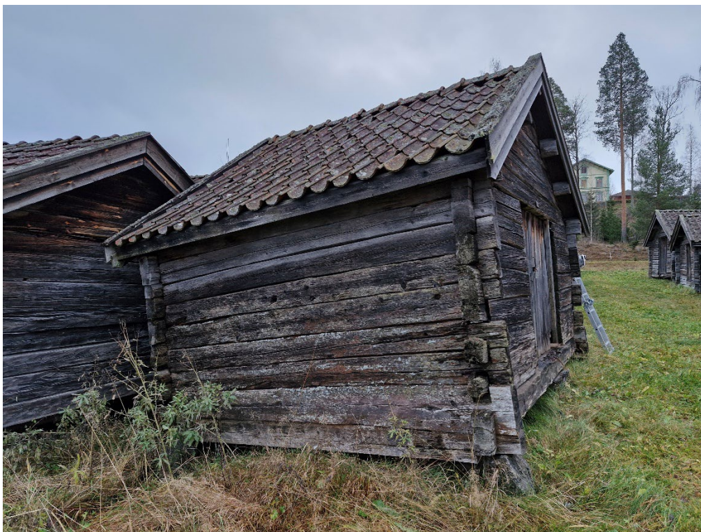
Figur 14. Kyrkstall som står snett och lutar kraftigt. Huset behöver lyftas och placeras på justerade grundstenar. Foto: Daniel Olsson, 2025-11-04.
