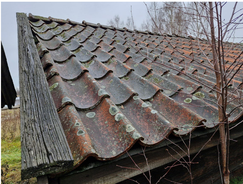
Figur 20. Detalj av tegeltak med glipa mellan den första nockpannan och vattbrädan samt rad med halva pannor, som delvis glidit ned så att det har bildats en öppning mellan de hela takpannorna och vattbrädan. På bilden framgår även hur skicket är på så gott som samtliga vattbrädor. Foto: Daniel Olsson, 2025-11-11.
