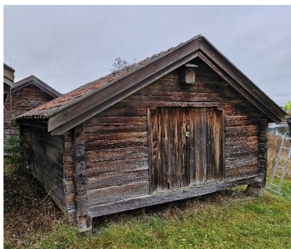
Figur 21. Kyrkstall med dubbla vindskivor. De övre vindskivorna har skadats på grund av att vattbrädorna ovanpå har blivit rötskadade. Foto: Daniel Olsson, 2025-11-11.
