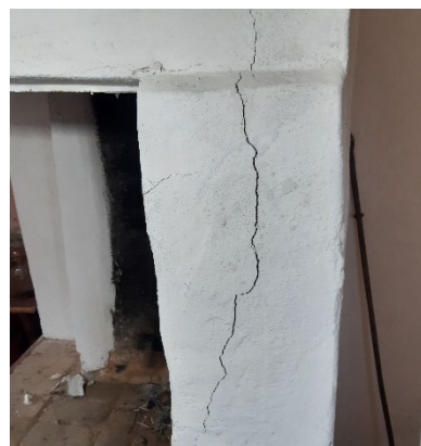
Figur 19. Detalj av spricka i den öppna spisens bögra del. Foto från nordöst, Daniel Olsson, 2024-10-29.
