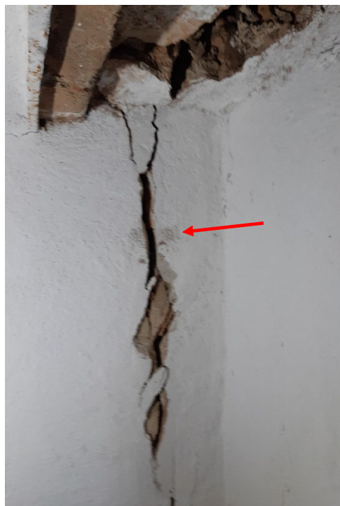
Figur 12. Detalj av spricka i den vänstra delen av mellanstugans öppna spis. Spår av en bortramlad gipstolk markerad med en pil i bilden. Foto från nordöst: Daniel Olsson, 2024-10-29.
