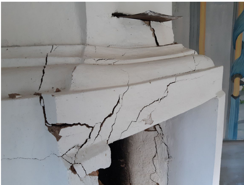
Figur 11. Detalj av de omfattande sprickorna i den öppna spisen i herrstugan. Foto från sydväst: Daniel Olsson, 2024-10-29.
