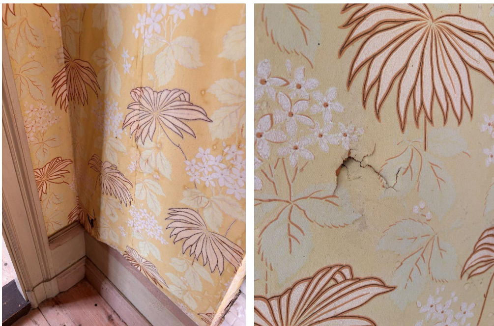
Figur 6 och 7. Närbild på skada i tapeten i muren till vänster om kakelugnen. Till höger syns en större mekaniskt tillfogad skada i tapeten. Foto: Ulrika Olsson, 2026-07-02.
