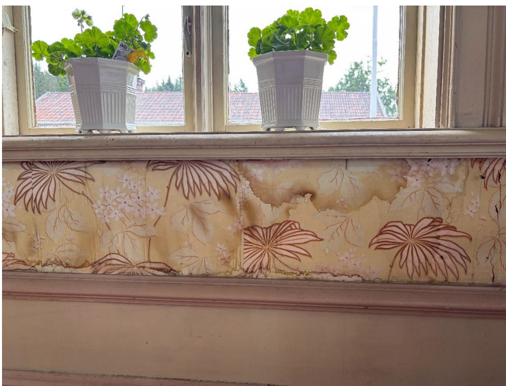
Figur 8. Under fönstren fanns fuktrosor i tapeten. Foto: Ulrika Olsson, 2026-07-02.
