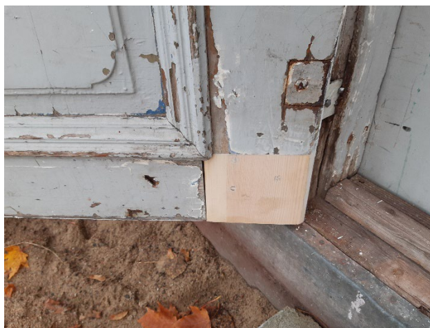
Figur 26. Detalj av lagning i det östra dörrbladet östra hörn. Foto från väster: Daniel Olsson, 2024-10-18.
