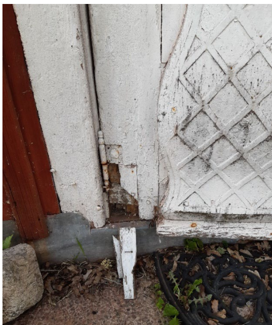
Figur 15. Detalj av tidigare lagning som släppt på huvudentréns östra dörrblad. Foto från norr: Daniel Olsson, 2023-06-15.
